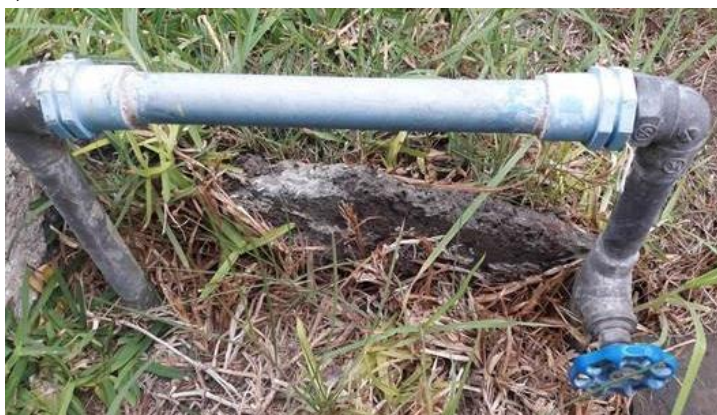
Imagen 11.3: Línea de agua potable, en donde se encuentra la llave de paso para alimentación del sector de oficinas.
