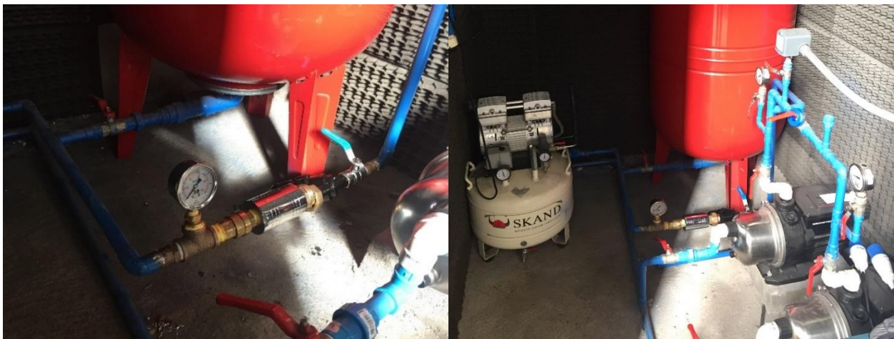
Imagen 8.4: Sistema AIV instalado en la sala de bombas, inmediatamente aguas arriba del sistema de bombeo.
