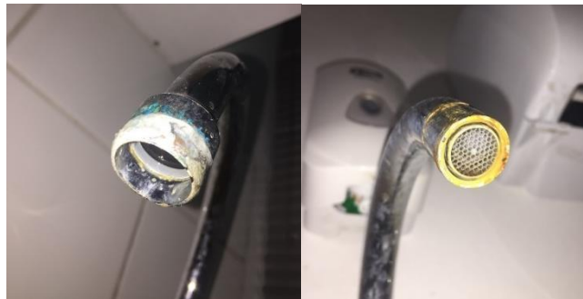
Imagen 8.15: Condición inicial de la salida de la grifería del lavaplatos, de la zona para café de las oficinas, y del comedor del laboratorio, de izquierda a derecha respectivamente.
