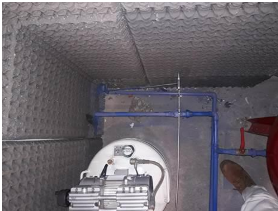
Imagen 8.1: Línea de salida de la bomba de impulsión, de la red de AP del Laboratorio.
