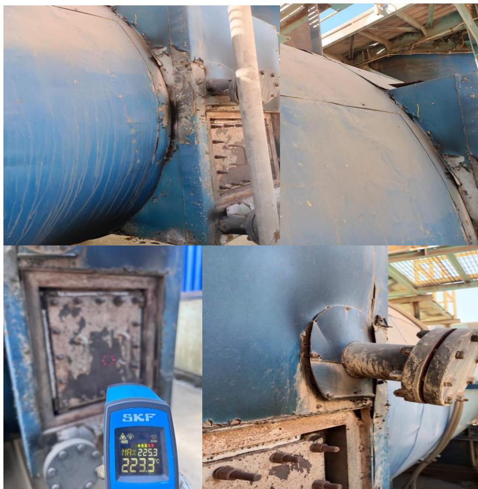
Figura 2-13. Condiciones subestándares de la caldera.
