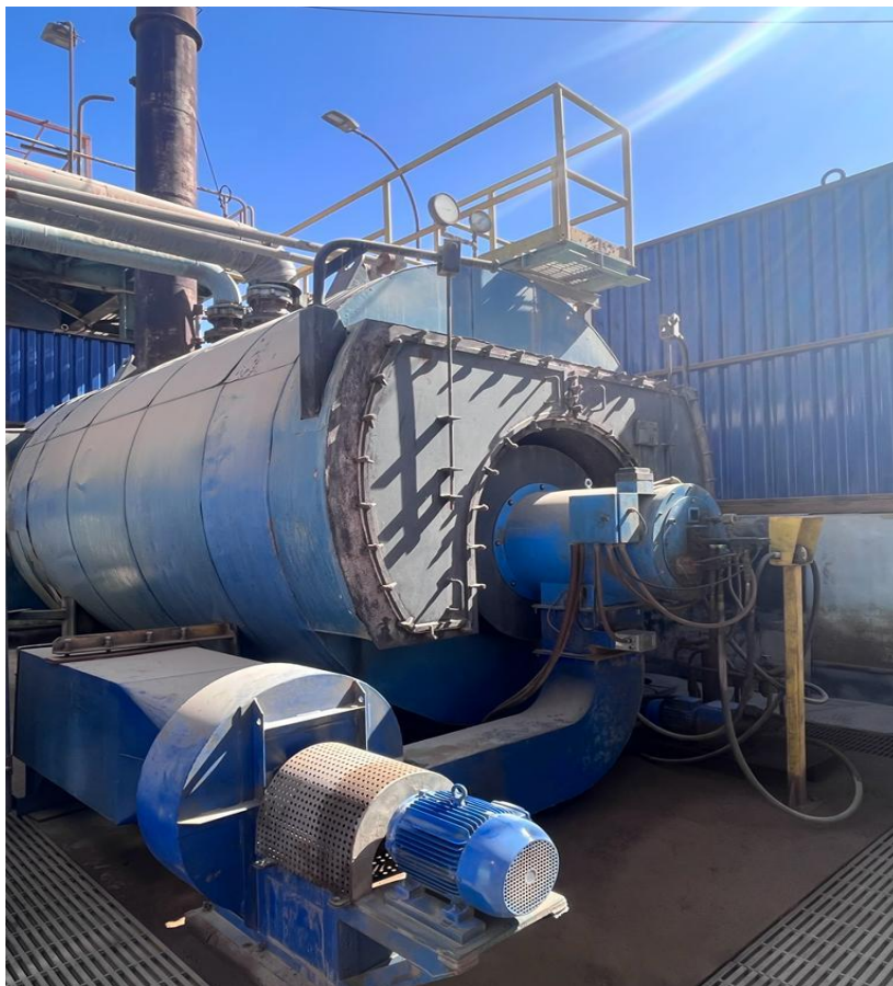
Figura 2-3 vista general de la caldera 410.
