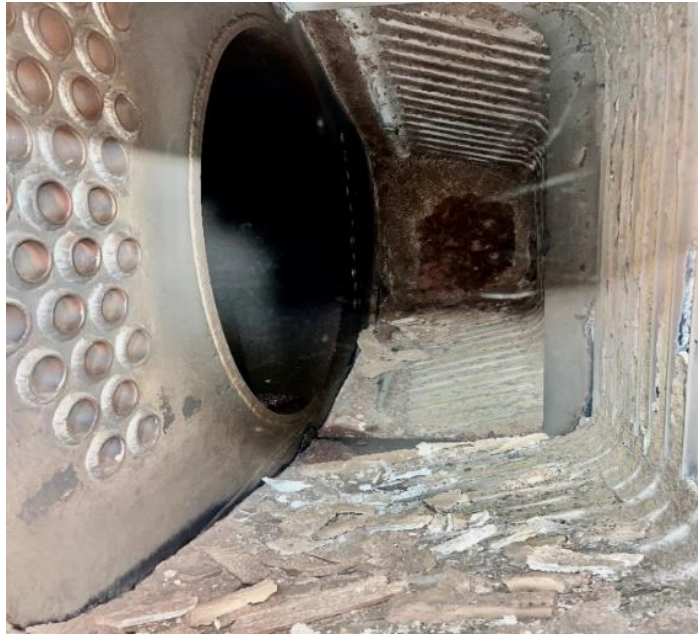
Figura 3-11. Concreto refractario dañado en la caja de humos. Calentador babcock.
