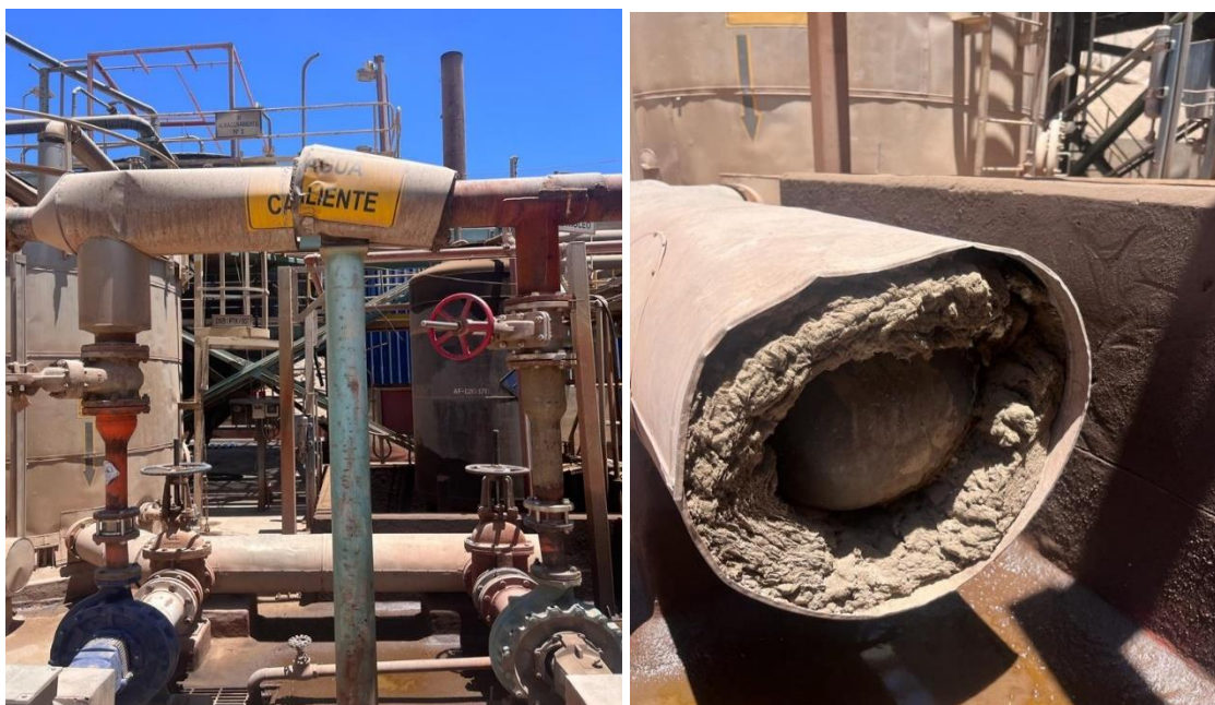
Figura 2-14. Imágenes de condiciones en cuadro de bombas para impulsión de agua caliente.
