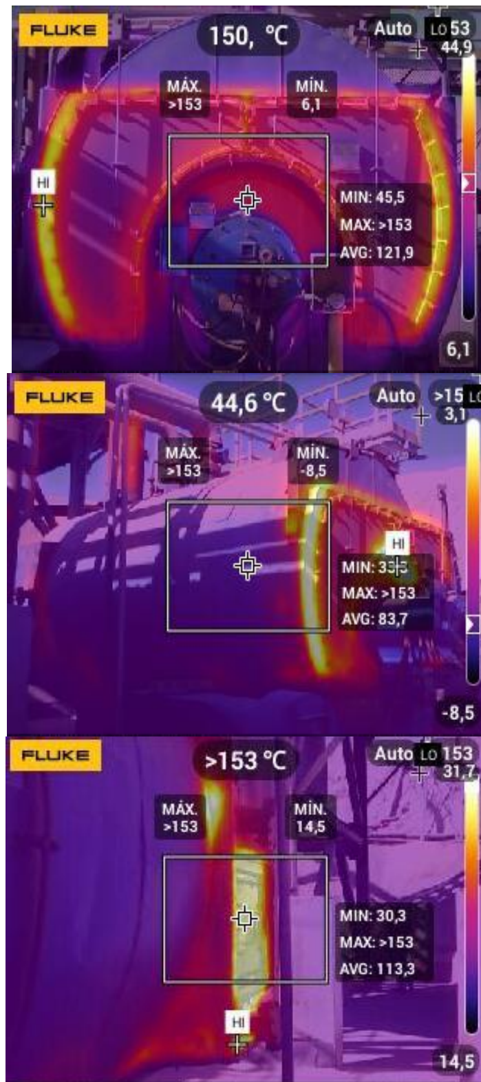
Figura 2-12. Imágenes térmicas de caldera 410.
