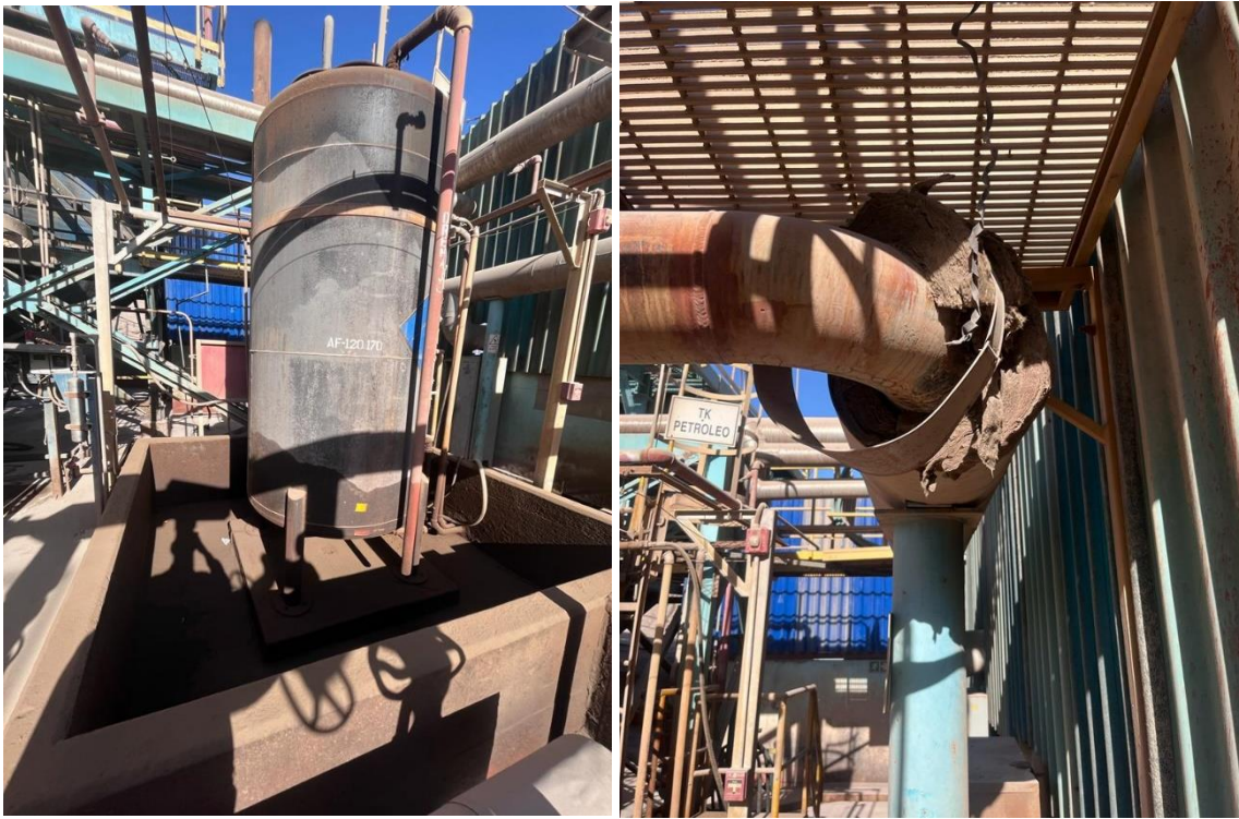
Figura 2-15. Líneas de descarga agua caliente y estanque de petróleo.
