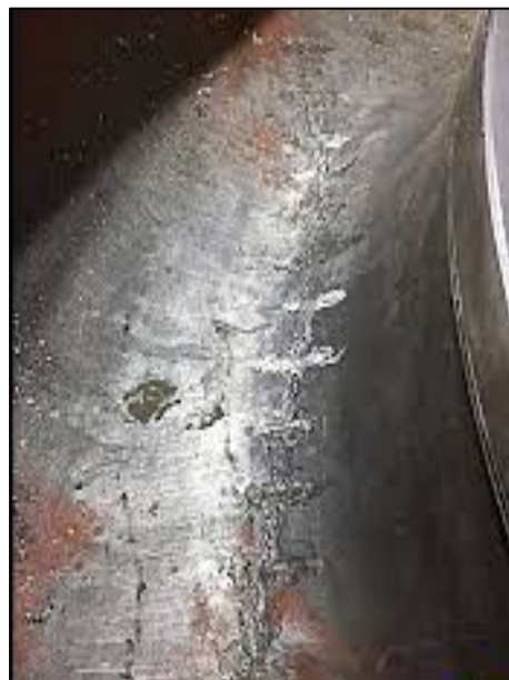
Figura 1-17: Fisura Main Frame MP 1000 (Adnindustrial.cl).
