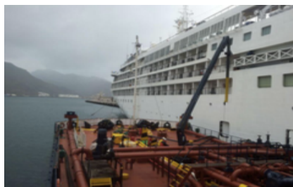
Figura N° 1-8: En la imagen se presenta una bomba de un barcaza de carga y descarga, estas bombas están en cada tanque de la barcaza.
