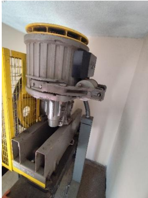
Figura 28: Imagen Motor Existente Otis 14 VTR. Fuente: Elaboración Propia.
