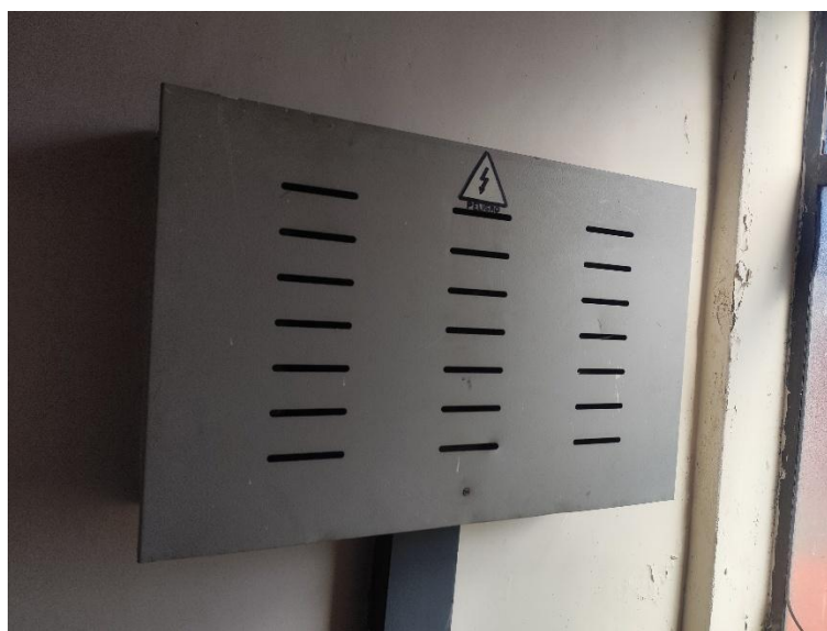
Figura 31: Imagen Gabinete de Resistencia. Fuente: Elaboración Propia.
