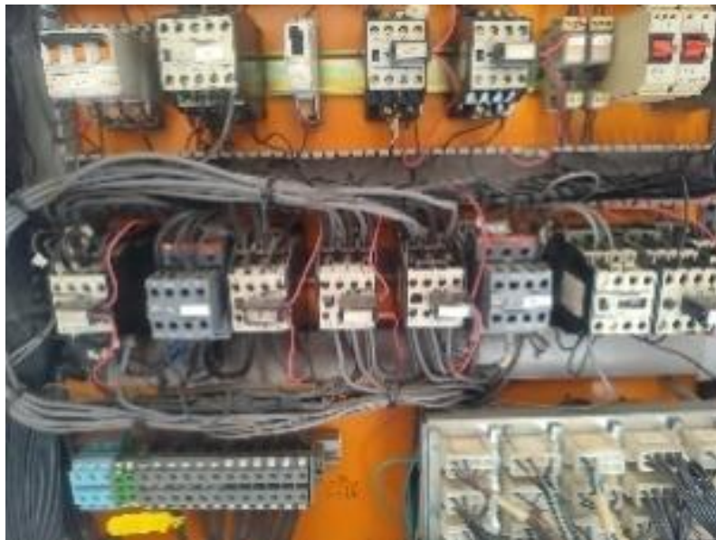
Figura 14: Imagen Control de Motor Ascensor. Fuente: Elaboración Propia.
