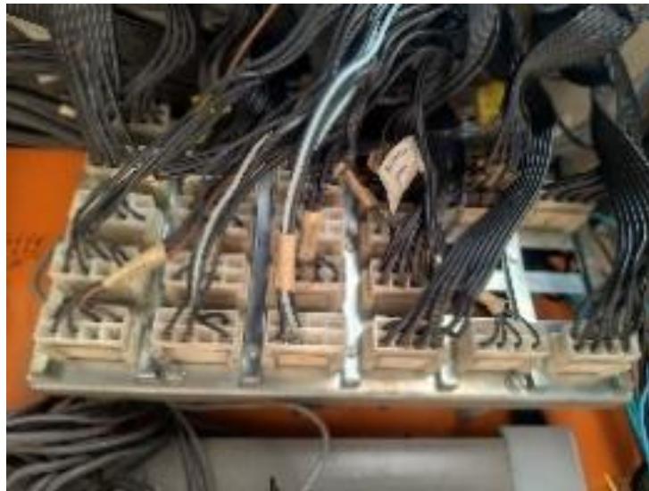
Figura 29: Imagen Cableado del Control Existente. Fuente: Elaboración Propia.
