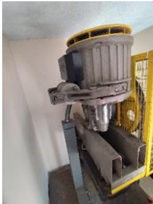
Figura 8: Imagen Motor Ascensor. Fuente: Elaboración Propia.
