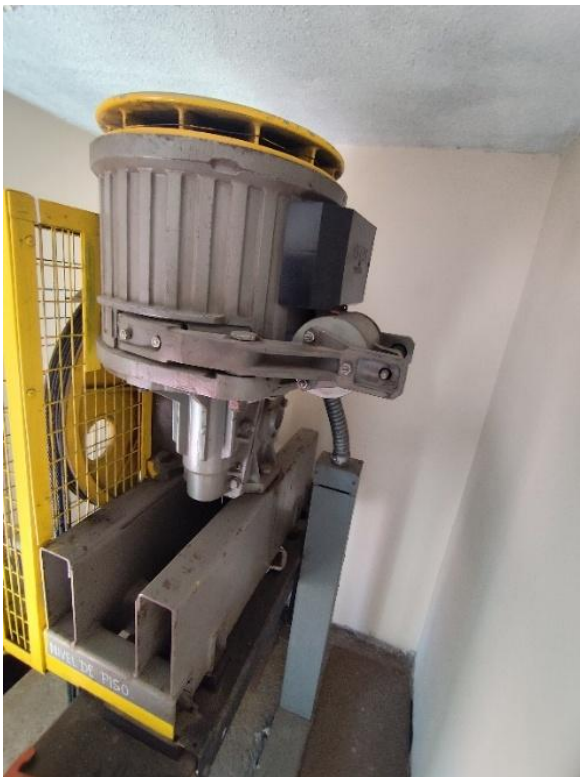
Figura G.2: Motor Otis 14 VTR en sala de máquinas. Fuente: Elaboración propia
