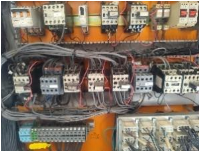
Figura G.1: Tablero de control original del ascensor. Fuente: Elaboración propia
