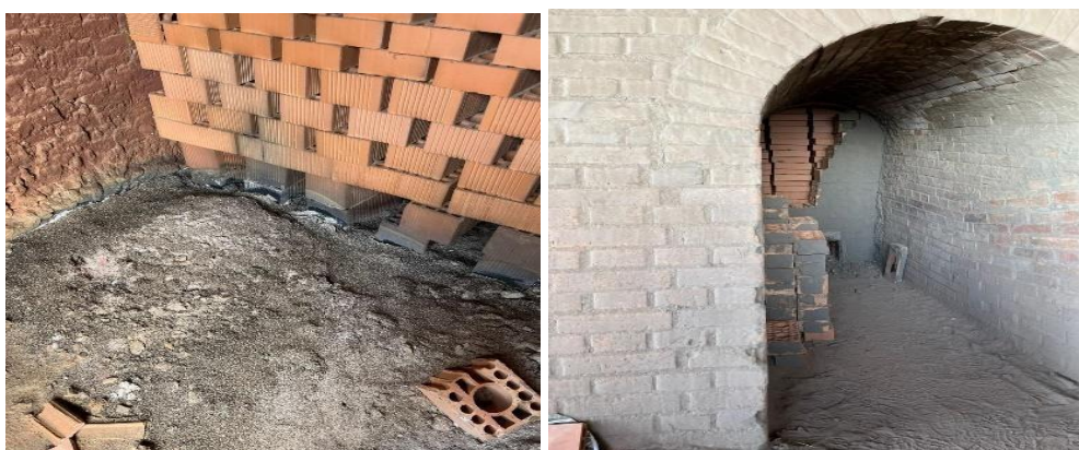
Imagen N°32 y 33: Evidencias asociadas a la falta de protocolo de limpieza en hornos.
