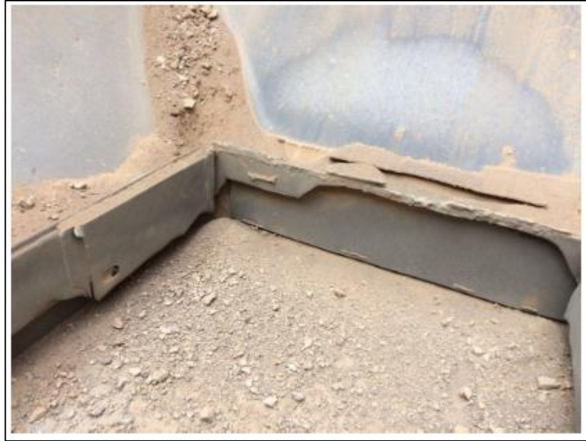
Figura 2-14 Cámara de chancado (3)
