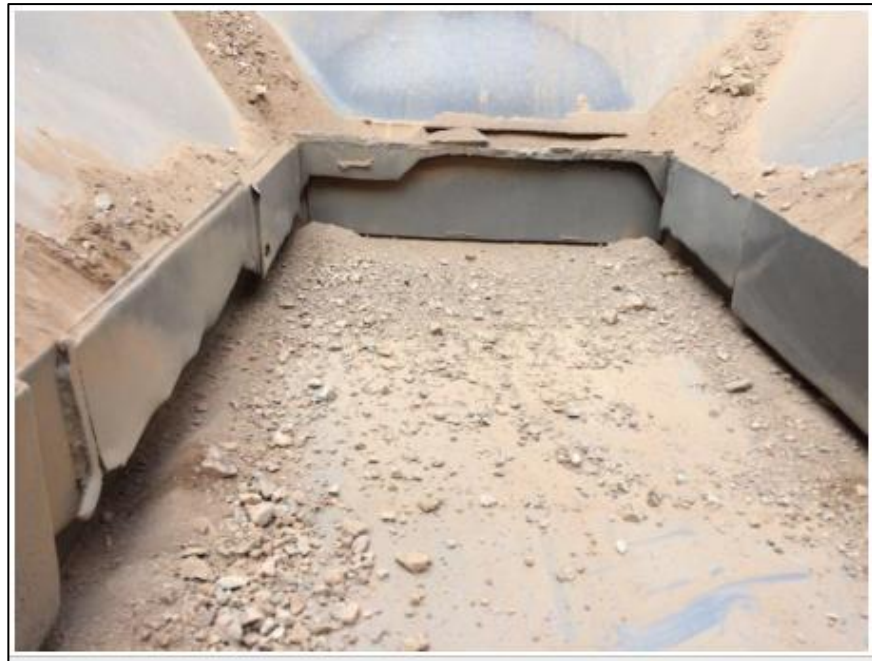
Figura 2-12 Cámara de chancado
