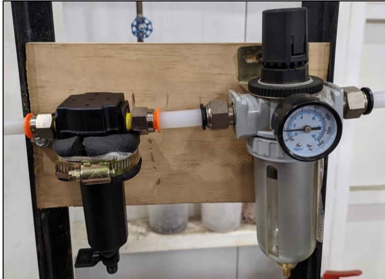
Imagen 25: Filtro de aceite y trampa de agua montados de izq. a dcha.
