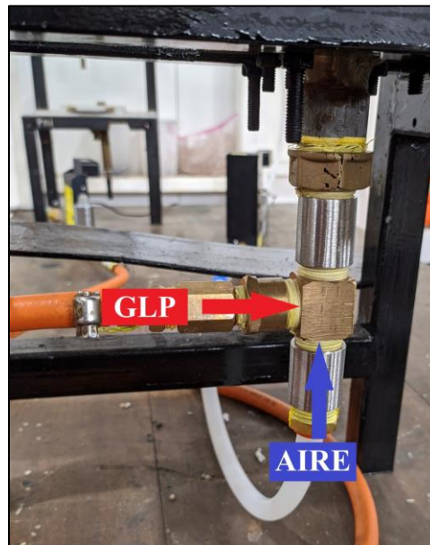
Imagen 32: Conexión para la inyección de GLP y aire.
