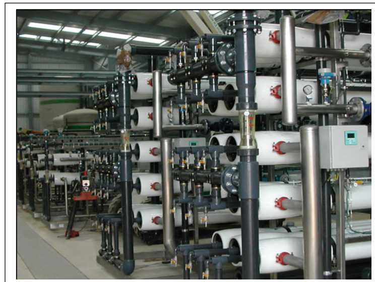
Figura 7.- Planta de Ósmosis Reversa.
