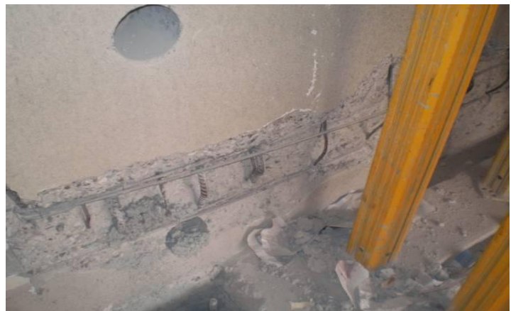
Figura 8.- Daños en Muro L Eje 4, Nivel Primer Piso
