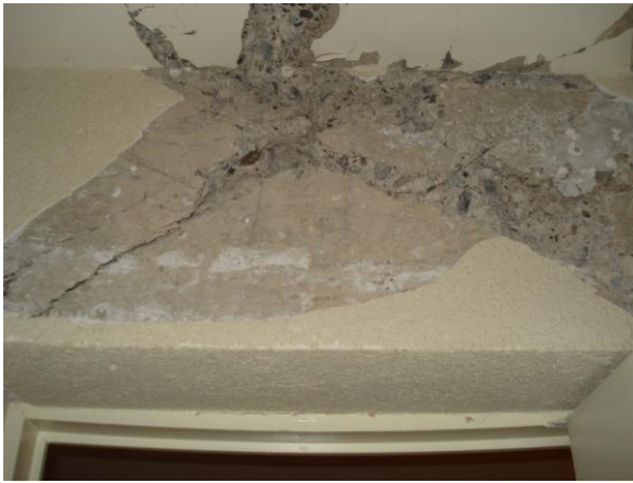
Figura 21.- Agrietamiento en dintel de acoplamiento, Eje F
