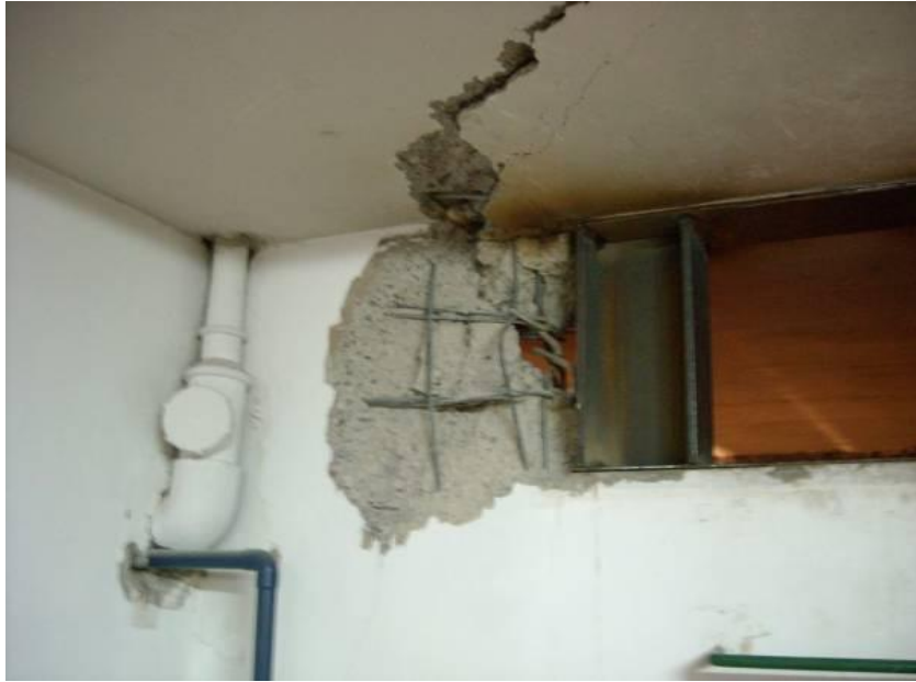
Figura 13.- Daños en Muro Eje 7, Nivel Subterráneo
