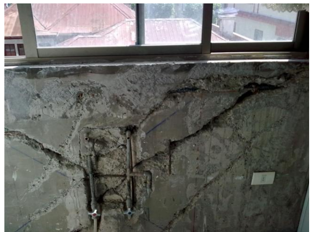
Figura 15.- Daños en antepecho, Eje 1
