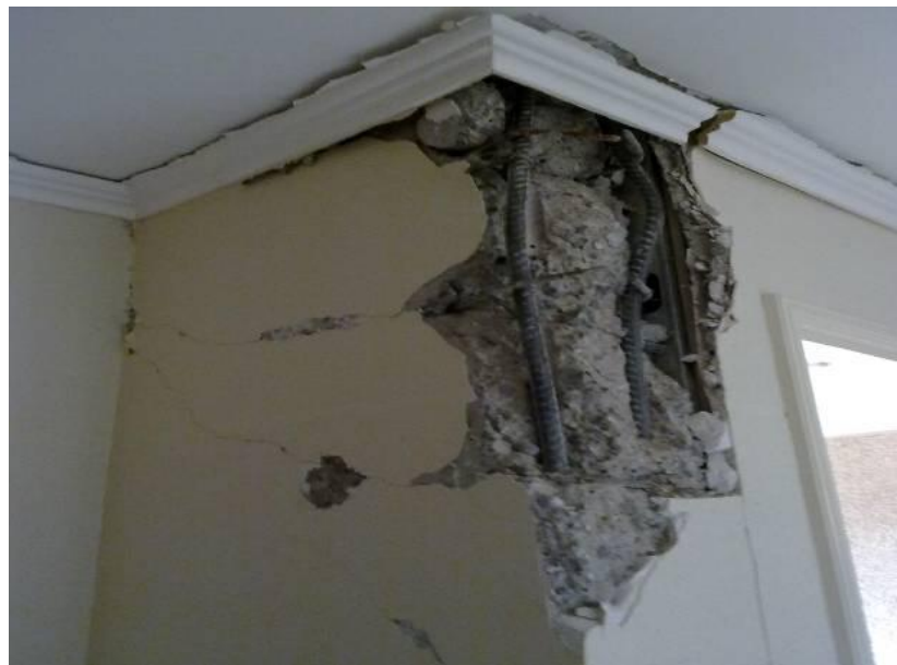
Figura 19.- Pandeo y pérdida del recubrimiento en Piso 13, Eje 8
