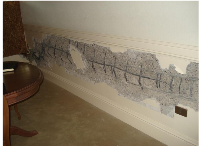
Figura 7.- Daños en Muro L Eje 4, Nivel Primer Piso
