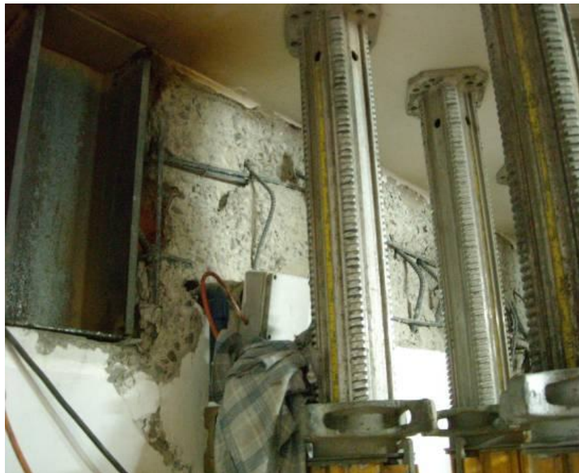
Figura 14.- Daños en Muro Eje 7, Nivel Subterráneo
