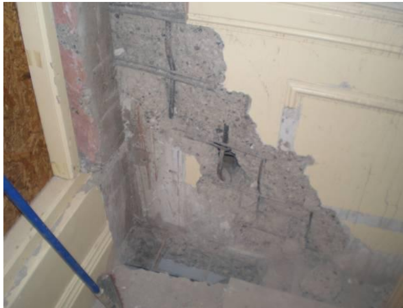
Figura 12.- Daños en Muro Eje 7, Nivel Primer Piso
