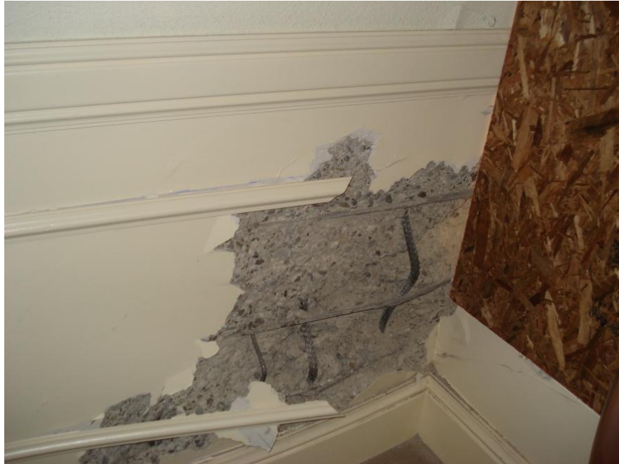
Figura 11.- Daños en Muro Eje 7, Nivel Primer Piso
