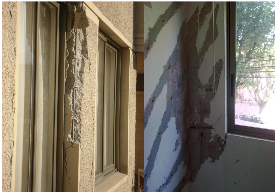
Figura 17.- Daños en machones, Eje B
