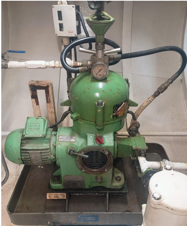
Figura 2: fotografía separador centrífugo en terreno Fuente: elaboración Propia
