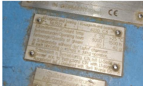
Figura 46: Placa de motor eléctrico con recomendación (Fuente: Fotografía propia)
