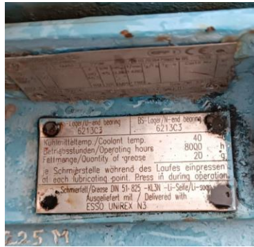
Figura 45: Placa de motor eléctrico con recomendación (Fuente: Fotografía propia)
