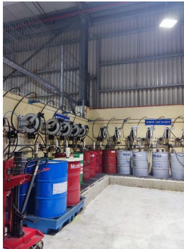
Figura 41: Taller de lubricación-oleohidráulica (Fuente: Fotografía propia)
