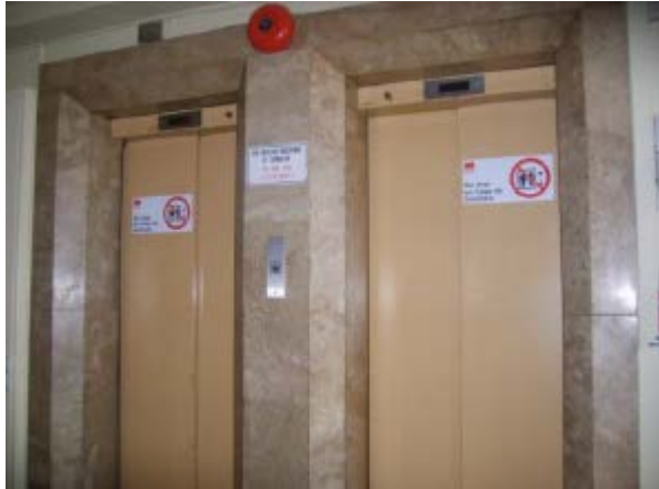
Figura N° 5: Puertas correderas de un ascensor, seminario CDT "Diseño y compra de ascensores".
