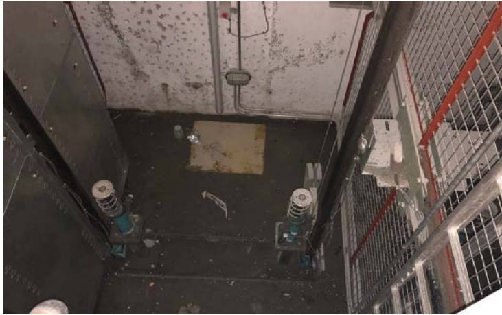
Figura N° 8: Amortiguadores, Edificio Concepto Smart, Concepción.
