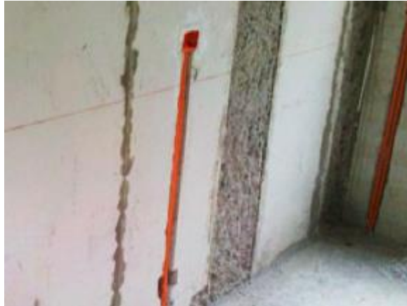
Figura 2-36 Socavado de Instalación Eléctrica
