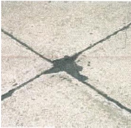
Figura 65: Bacheos menores de severidad baja. [6]
