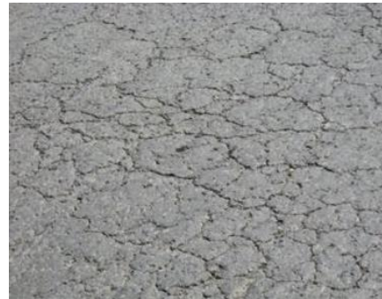
Figura 20: Grietas de Piel de Cocodrilo de severidad media [6].
