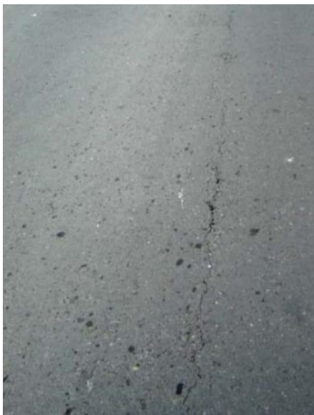
Figura 36: Grieta longitudinal de severidad baja. [6]
