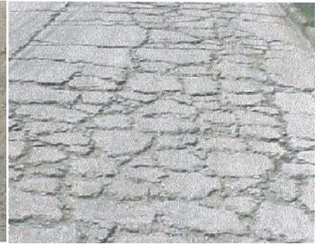
Figura 74: Grietas de Mapeo de severidad alta. [6]
