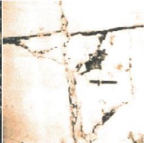
Figura 87: Desprendimiento de esquina de severidad alta. [6]
