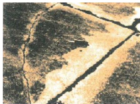
Figura 54: Grieta de Esquina de severidad media. [6]
