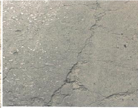
Figura 73: Grietas de Mapeo de severidad media. [6]
