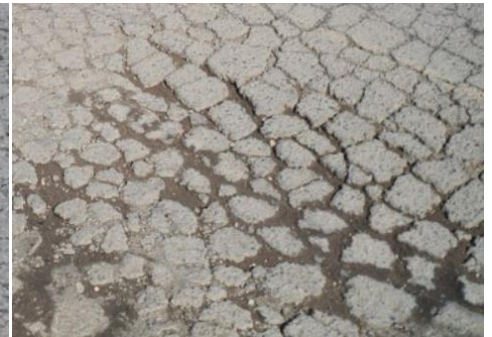
Figura 21: Grietas de Piel de Cocodrilo de severidad alta [6].
