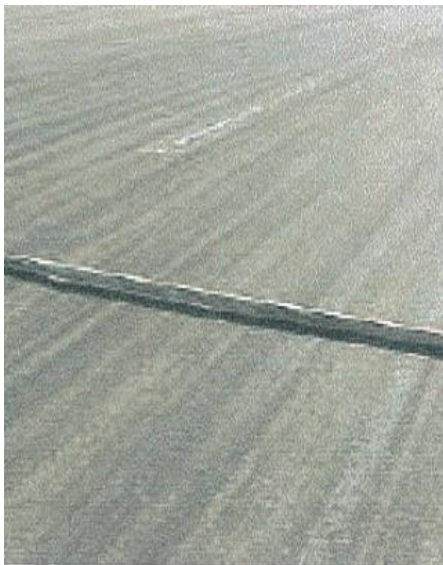
Figura 46: Ahuellamiento de severidad baja. [6]
