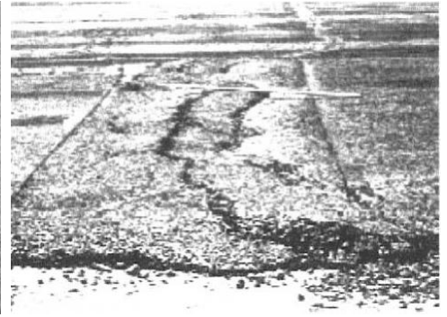
Figura 52: Hinchamiento de severidad alta. [6]
