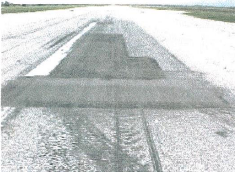
Figura 40: Bache de severidad baja. [6]
