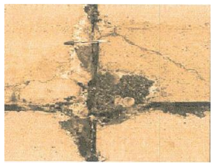
Figura 55: Grieta de Esquina de severidad alta. [6]
