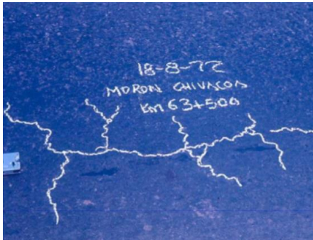
Figura 19: Grietas de Piel de Cocodrilo de severidad baja [6].
