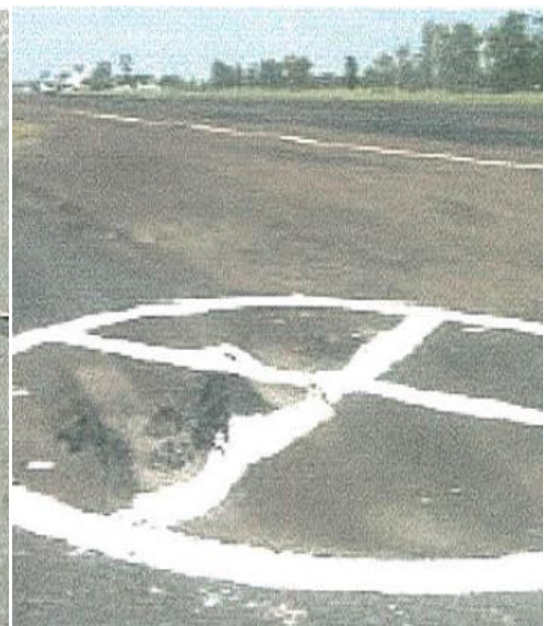
Figura 48: Ahuellamiento de severidad alta. [6]
