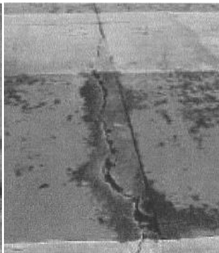
Figura 83: Desprendimiento en Junta de severidad media. [6]
