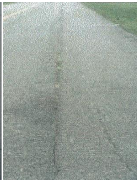
Figura 37: Grieta longitudinal de severidad media. [6]
