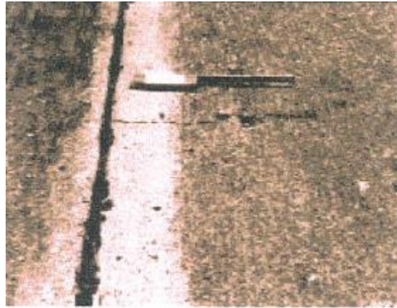
Figura 81: Grietas por Retracción. [6]
