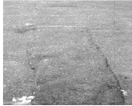
Figura 51: Hinchamiento de severidad media. [6]
