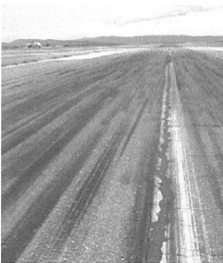
Figura 23: Grietas de bloque de severidad baja. [6]
