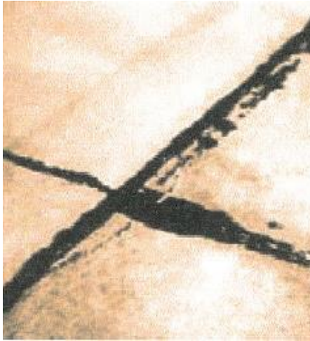
Figura 85: Desprendimiento de esquina de severidad baja. [6]
