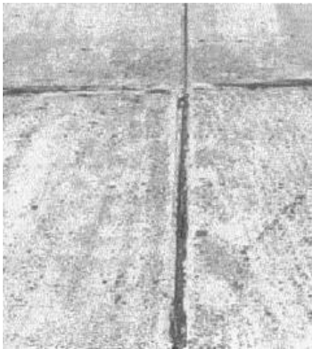
Figura 62: Daño en Sello de junta de severidad baja. [6]
