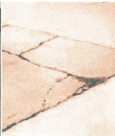
Figura 79: Grietas de bloque de severidad media. [6]
