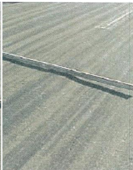
Figura 47: Ahuellamiento de severidad media. [6]
