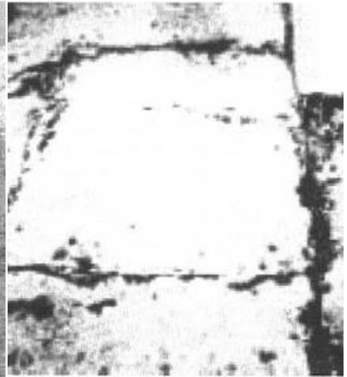
Figura 70: Bacheos mayores de severidad alta. [6]
