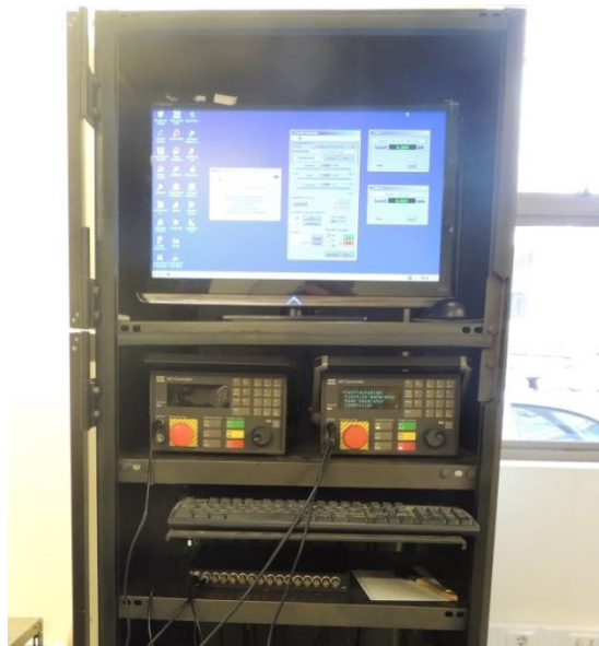
Figura 4-5 Gabinete con controlador MTS 407
