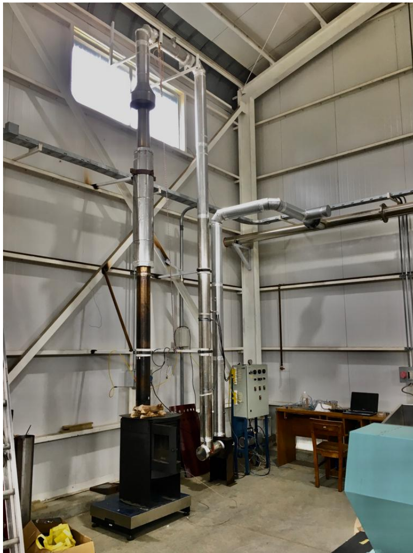
Figura 10: Entorno de pruebas, vista general del túnel de dilución montado en Sede JMC, UTFSM
