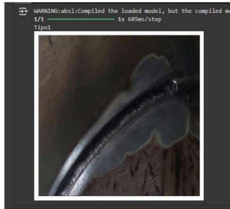
Ilustración 37- Caso Soldadura en buen estado Fuente: Elaboración propia Google Colab
