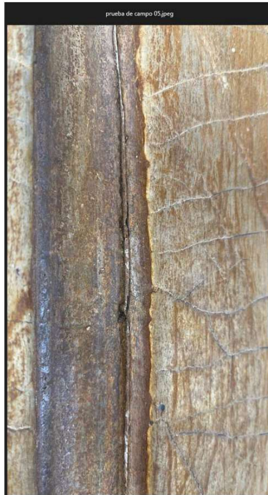
Ilustración 52-Prueba de campo Nr.6 Agrietamiento Fuente: Elaboración propia
