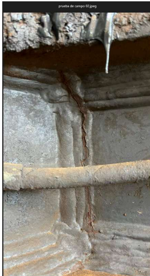
Ilustración 56- Prueba de campo Nro 8 Agrietamiento Fuente: Elaboración propia
