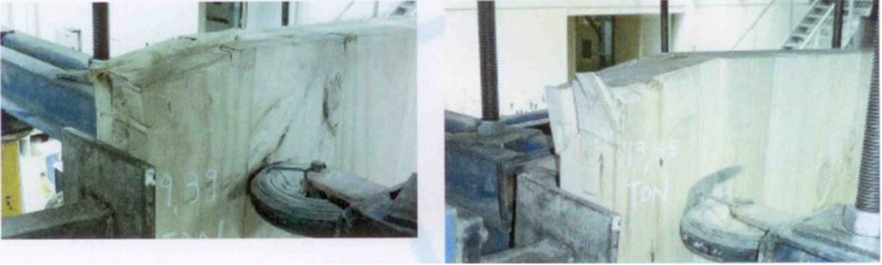
Figuras n°8 y n°9: Falla carga horizontal.
