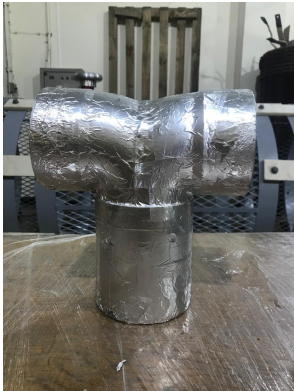
Codo de PVC, unión entre elevador de tensión, el conductor y el divisor capacitivo (Elaboración propia).
