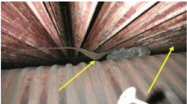
Figura 9: Barras anti - vibratorias deformadas 2008
