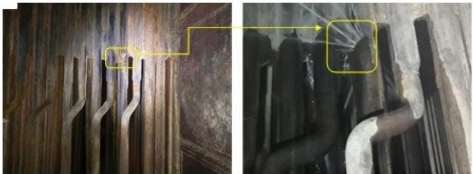
Figura 14: Fractura Panel N°2 tubo N°15 Banco Generador.
