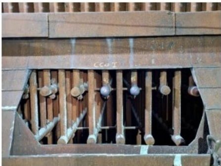
Figura 29: Economizador I – Lado Pared Frontal
