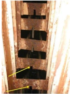
Figura 10: Ausencias de barras anti-vibratorias
