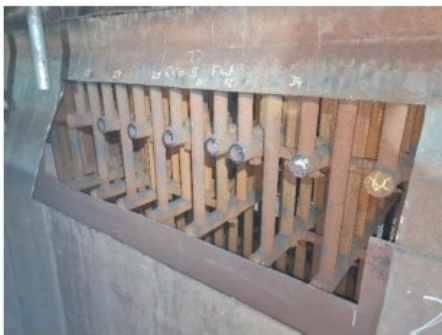
Figura 31: Economizador II – Lado Pared Frontal
