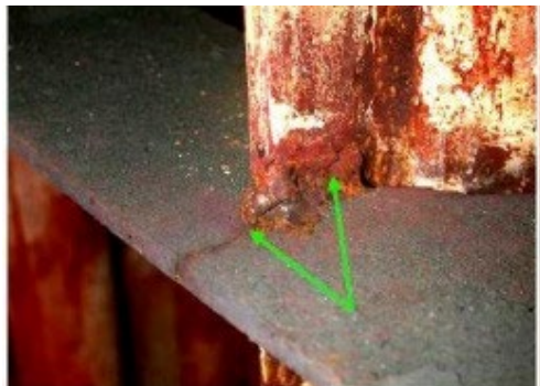
Figura 8: Grieta en aleta con proyección al tubo en banco generador. 2008
