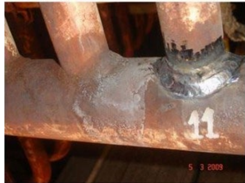
Figura 11: Rotura en unión tubo colector eco 2
