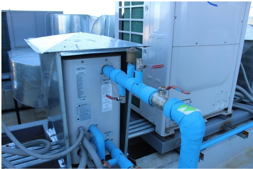
Figura 9 Equipos de inyección de aire
