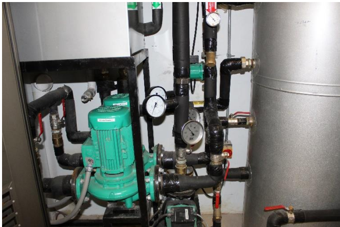
Figura 7 Sala térmica N°4 en pasillo del módulo 2
