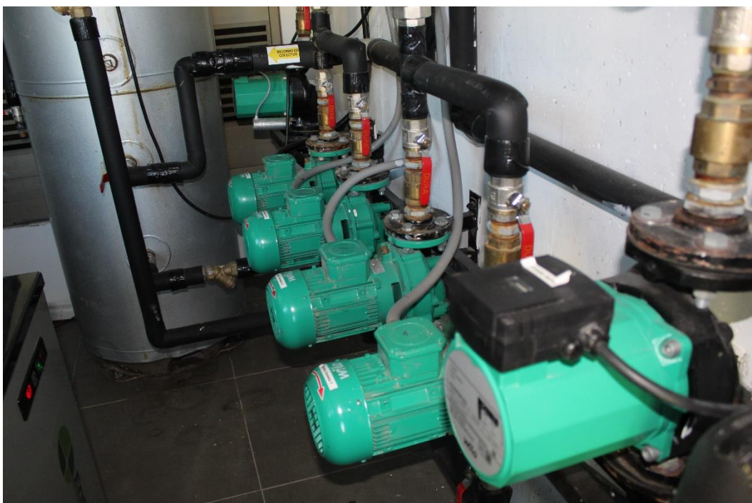
Figura 1: Sala térmica bajo escalera
