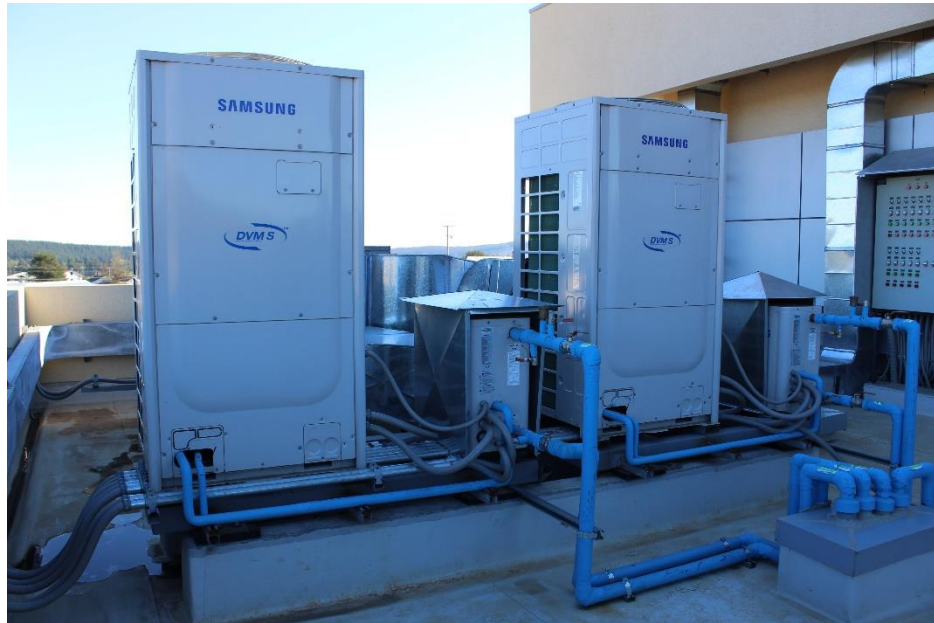
Figura 2 Bombas de calor para sala térmica N°1
