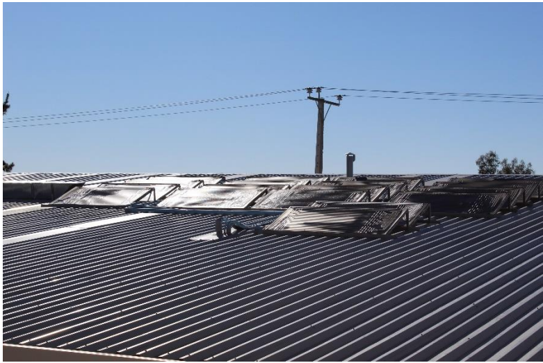
Figura 6 Maquinas aerotérmicas Samsung y paneles asociados al bloque termodinámico
