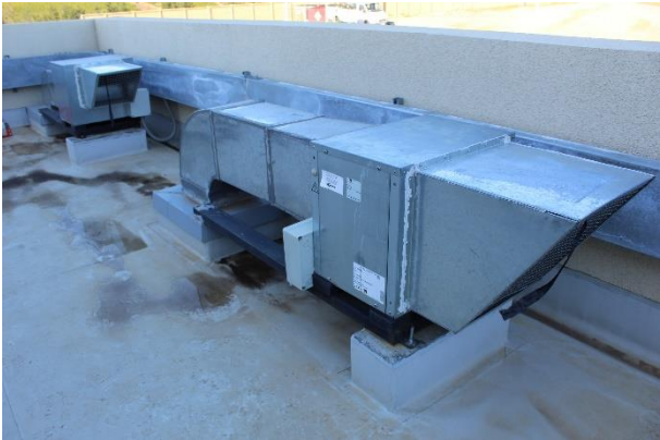
Figura 11 Ventilador de inyección cocina y extracción de lavandería
