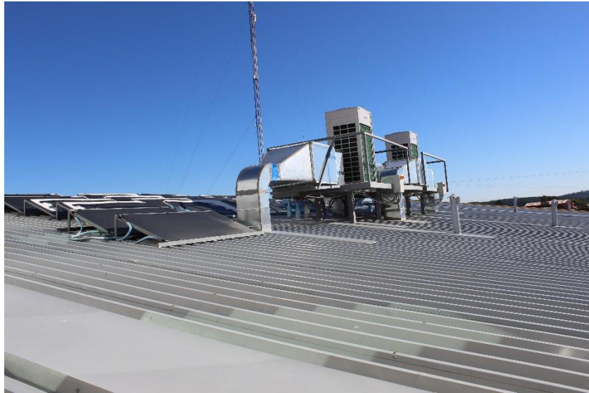
Figura 4Maquinas aerotérmicas y paneles solares
