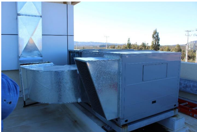
Figura 10 Equipos de inyección de aire a cocina caliente modulo N°5
