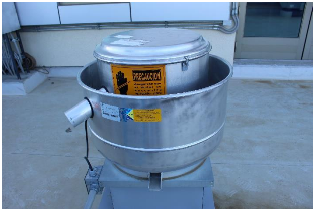
Figura 12 Ventilador extractor de cocina y extracción de lavandería caliente
