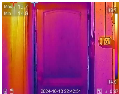
Ilustración 26. fotografía térmica de puerta de acceso principal de la vivienda
