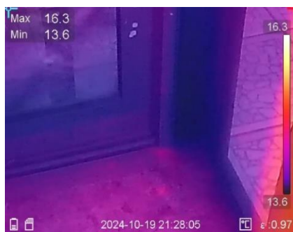
Ilustración 27. fotografía térmica de ventana tipo bow window
