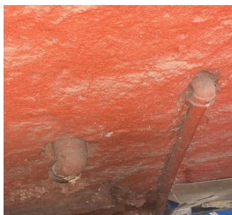
Ilustración 35. fotografía de conexión agua potable
