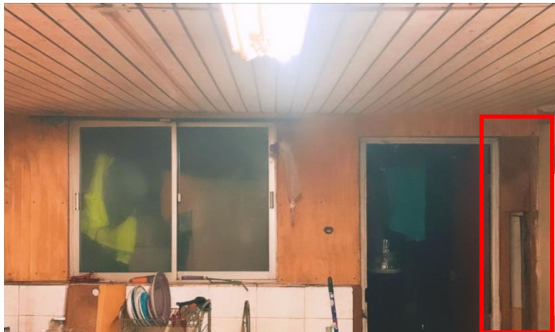
Ilustración 36. fotografía de muro oeste sector cocina
