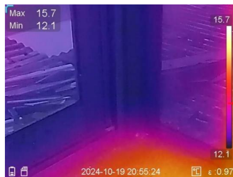
Ilustración 39. fotografía térmica de ventanas tipo bow window dormitorio 3 y 4
