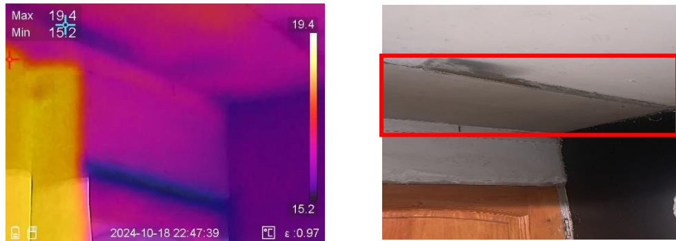
Ilustración 28. fotografías de interacción de muro con la losa
