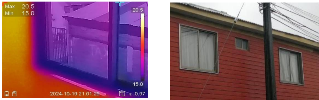
Ilustración 38. fotografía térmica de ventanas tipo corredera en dormitorios segundo nivel
