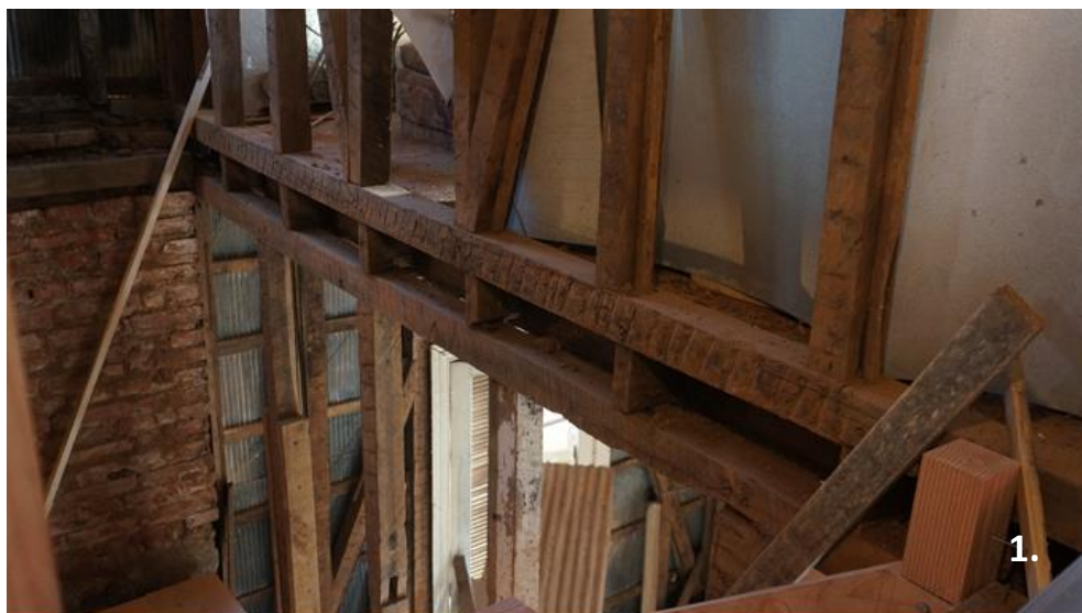
1. Fotografía del envigado de entepiso. Fuente: Colección fotográfica del autor, 2016.
