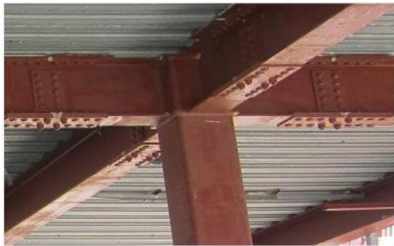
Figura 3-3. Conexión a momento con diafragma pasante analizada posterior al terremoto [Futamura. 2017].
