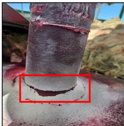
Ilustración 1-4 "Ensayo con Grietas"
