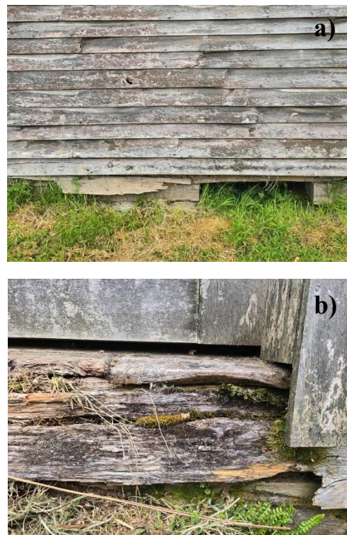
Figura 30. Deterioro en la zona basal de miembros expuestos. (a) Pieza en contacto directo con el terreno, con colonización biológica, musgo y líquenes. (b) Tinglado con erosión sobre tramo basal degradado. Fotografías de la autora, noviembre de 2025.
