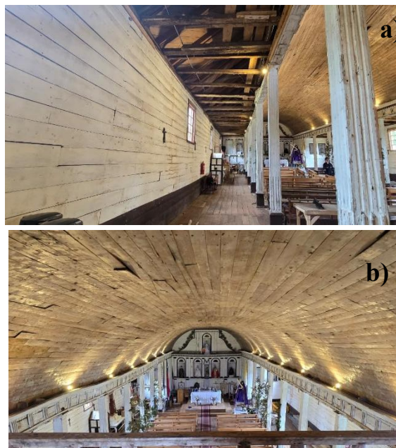
Figura 45. Criterio de superficies aptas establecido en terreno. Dos fotografías enfrentadas, (a) revestimiento de muro y pilares de la columnata con terminación pintada, no aptos, y (b) bóveda de cielo y estructura de entretecho con madera al natural, aptos. Fotografía de la autora, noviembre de 2025.
