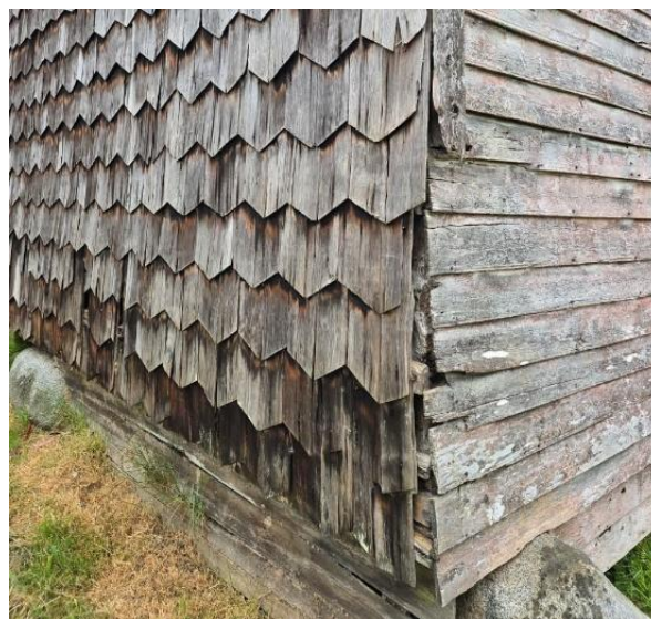
Figura 38. Revestimiento exterior de tejuelas con deterioro superficial visible. Fotografía de la autora, noviembre 2025.
