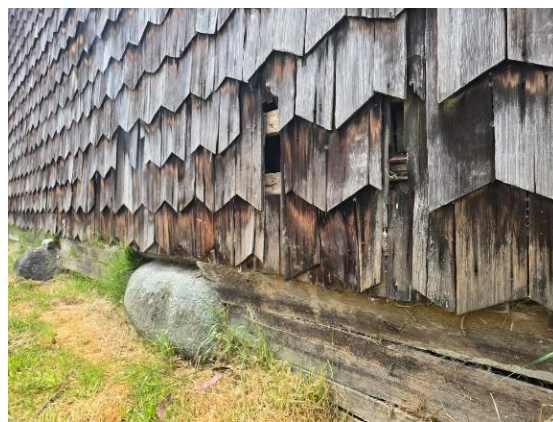
Figura 9. Daño visible en tejas de la iglesia. Fotografía de la autora, noviembre 2025.
