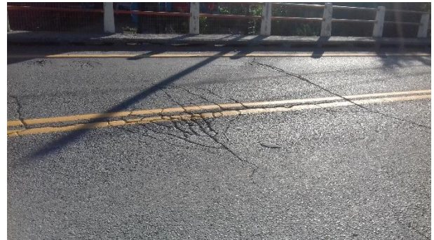
Figura 8-118 grieta en ambas direcciones del pavimento
