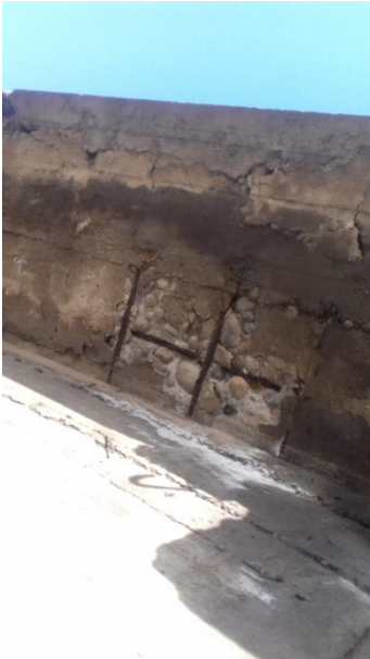
Figura 8-76 estribo con acero expuesto
