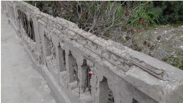
Figura 8-168 baranda en muy mal estado
