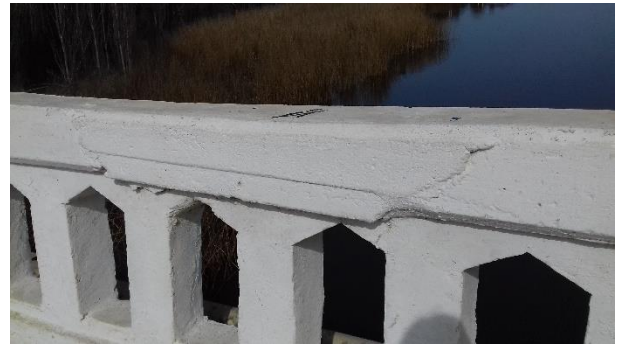
Figura 8-21 Baranda de hormigón en mal estado
