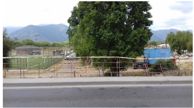
Figura 8-153 baranda rota y deformada
