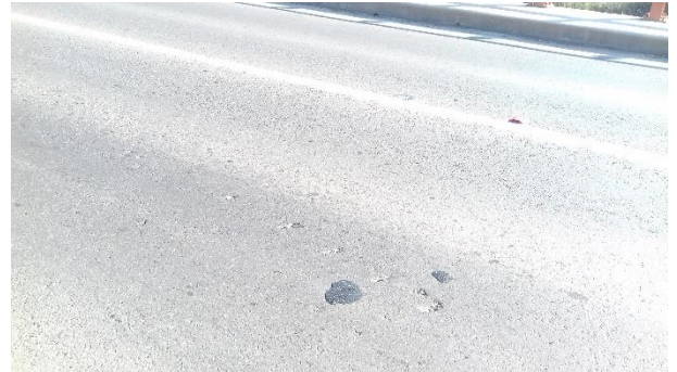
Figura 8-94 Grietas y hoyos en la vía
