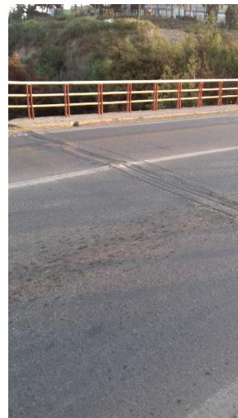
Figura 8-62 grietas en el pavimento
