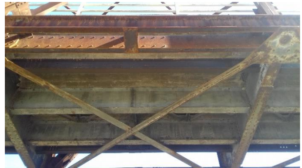
Figura 8-86 viga principal completamente oxidada
