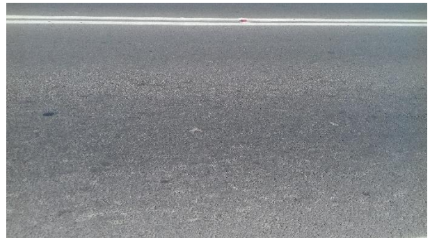
Figura 8-138 grietas menores en el pavimento
