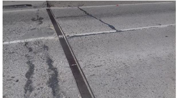
Figura 8-169 pavimento en mal estado
