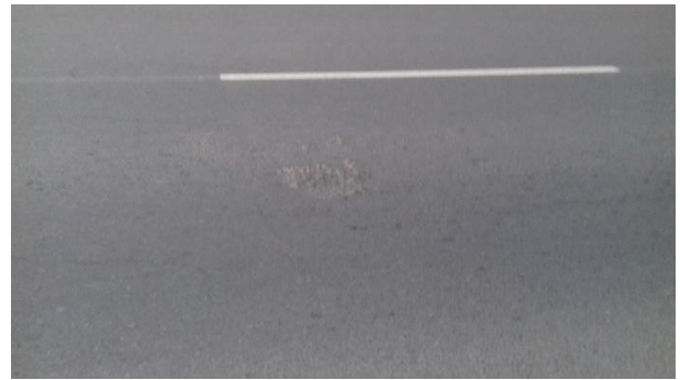
Figura 8-129 hoyos en el pavimento
