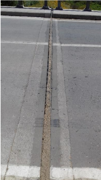
Figura 8-113 junta de expansión obstruida
