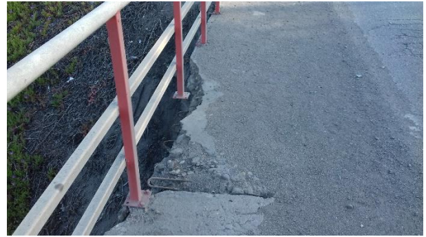
Figura 8-77 baranda en el aire, falta de vereda
