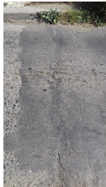
Figura 8-158 junta de expansión tapa por asfalto
