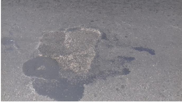
Figura 8-152 pavimento en mal estado
