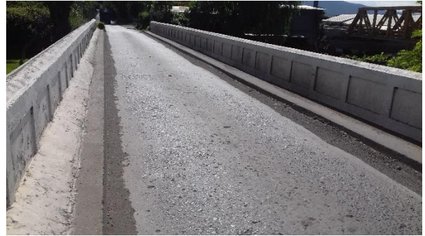
Figura 8-157 losa en mal estado
