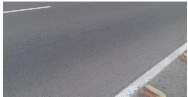
Figura 8-130 grietas en la vía
