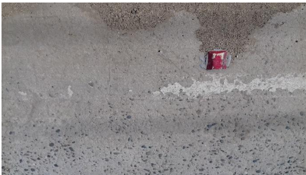
Figura 8-3 Decoloración línea en la vía
