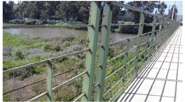
Figura 8-65 baranda de acero oxidada
