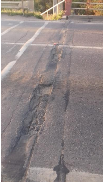
Figura 8-60 grieta y baches en la vía
