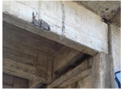
Figura 8-37 Viga principal con descascamiento
