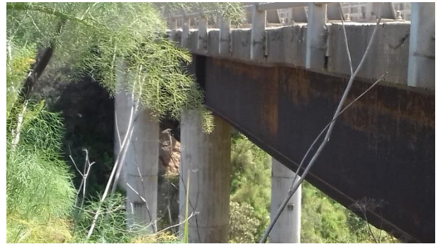
Figura 8-33 Viga principal oxidada
