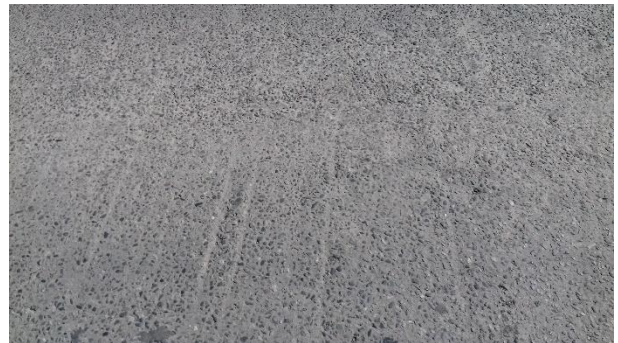
Figura 8-134 grietas en la capa de hormigón
