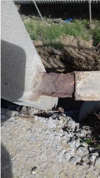
Figura 8-36 Baranda con corrosión
