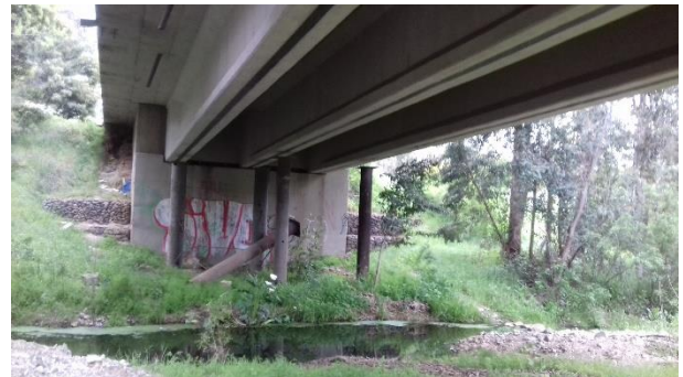
Figura 8-107 pilares oxidados no pegados a las vigas
