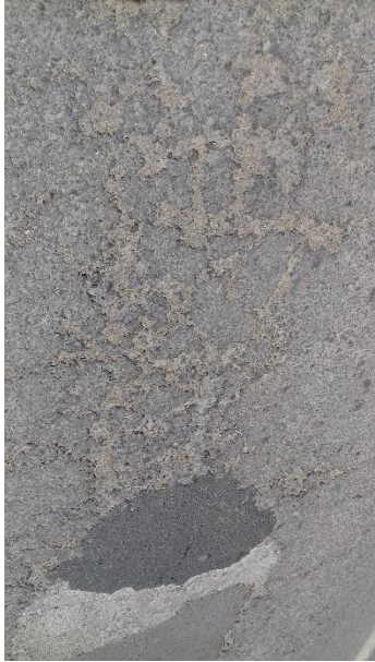
Figura 8-164 baches y grietas en la losa
