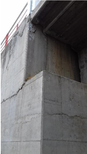
Figura 8-44 falla en el apoyo, corte prolongado
