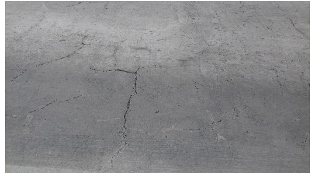
Figura 8-106 piel de cocodrilo en la vía
