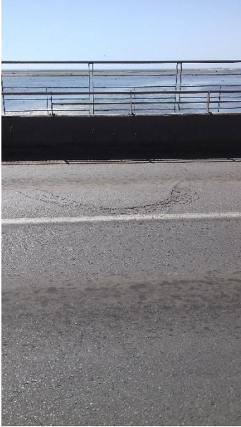
Figura 8-52 grieta y bache en el pavimento de asfalto
