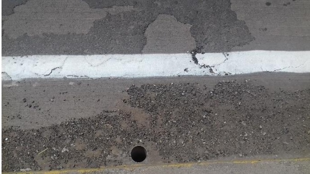
Figura 8-144 carpeta en muy mal estado
