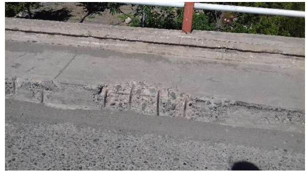
Figura 8-82 acero expuesto en la vereda
