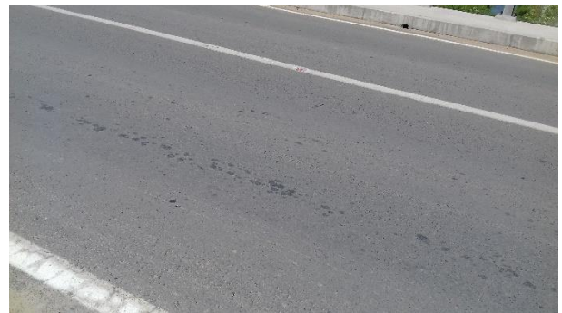
Figura 8-115 pequeñas deformaciones en el pavimento
