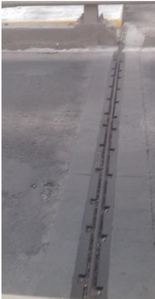
Figura 8-125 hoyos en la vía cerca de la junta de expansión
