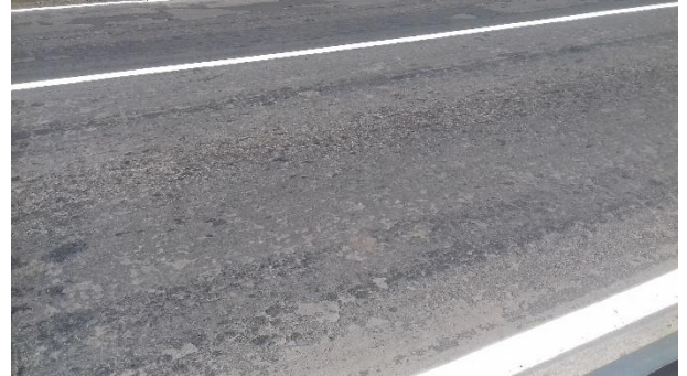
Figura 8-145 carpeta en muy mal estado
