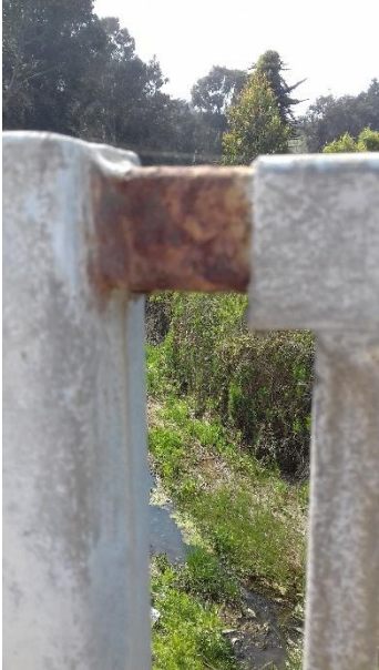
Figura 8-28 Baranda de acero oxidada
