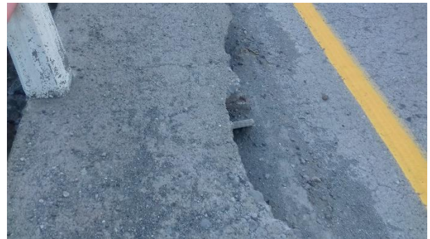
Figura 8-123 Vereda con socavación
