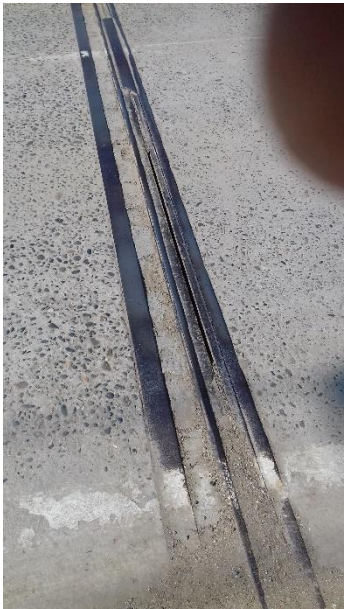
Figura 8-7 Junta de expansión obstruida con tierra
