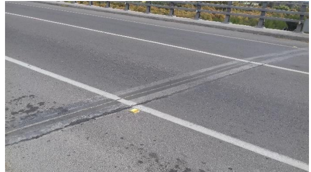
Figura 8-161 pavimento en mal estado
