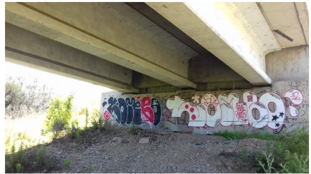
Figura 8-114 soporte sísmico muy bajo
