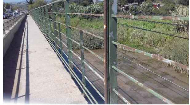
Figura 8-53 baranda de acero oxidada
