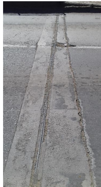
Figura 8-54 junta de expansión obstruida con baches en el asfalto
