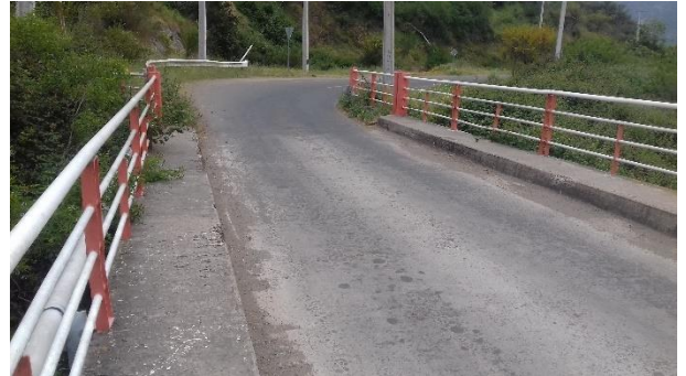
Figura 8-149 pavimento en mal estado
