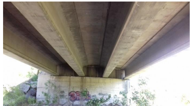
Figura 8-111 topes sísmicos bajos
