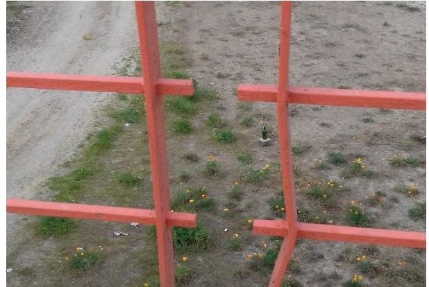
Figura 8-45 deformación en la baranda de acero
