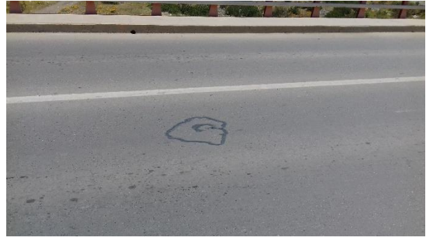
Figura 8-90 grietas menores en la vía
