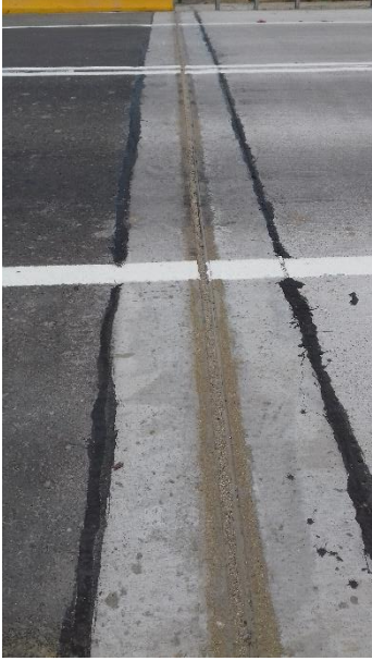
Figura 8-101 Junta de expansión levemente obstruida
