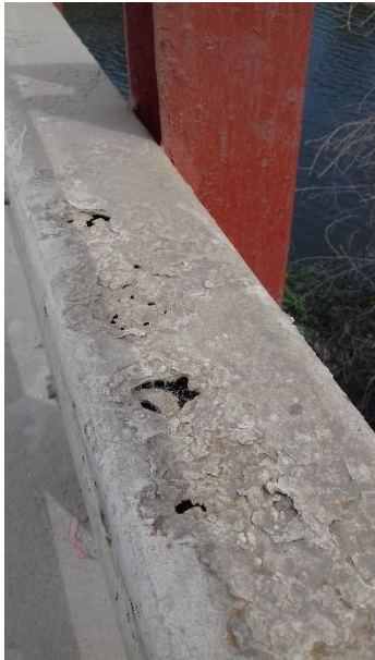
Figura 8-40 baranda de acero corroída
