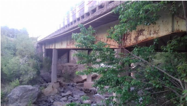
Figura 8-121 Viga principal oxidada
