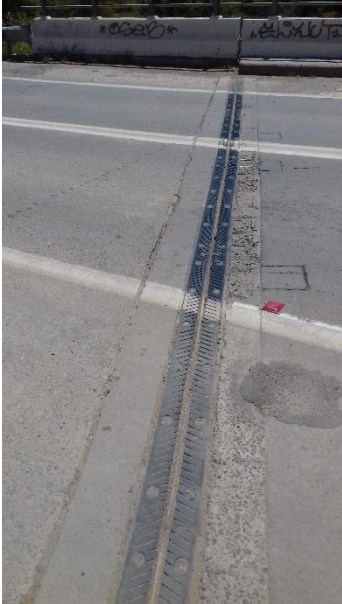
Figura 8-109 acero expuesto al lado de la junta de expansión
