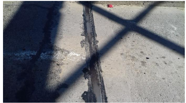
Figura 8-87 grietas en el pavimento
