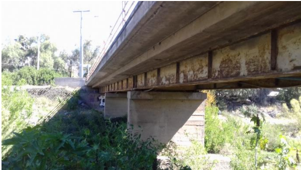
Figura 8-80 viga completamente oxidada
