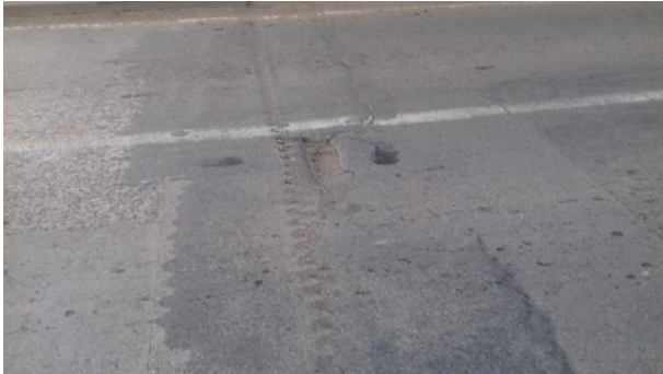
Figura 8-56 deformación de la vía al lado de la junta de expansión
