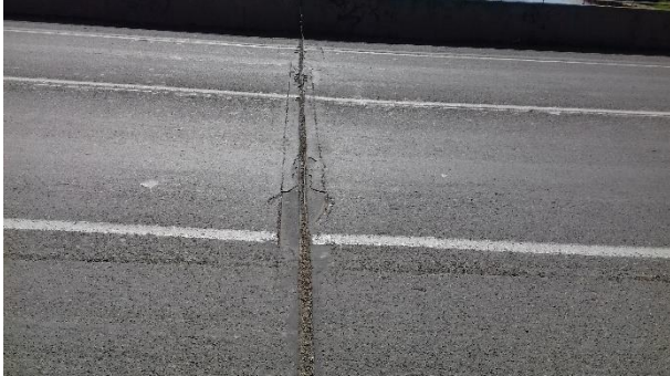
Figura 8-68 junta de expansión con asfalto roto
