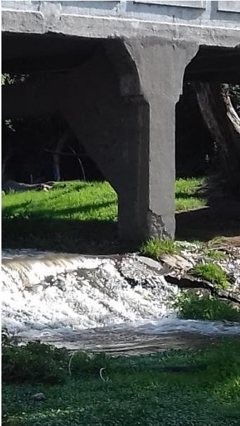
Figura 8-156 Descascaramiento de la base de la columna
