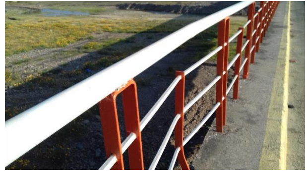
Figura 8-98 Baranda de acero deformada
