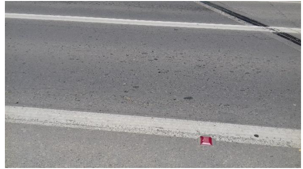
Figura 8-110 grietas en el pavimento
