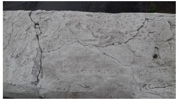
Figura 8-49 Baranda muy agrietada
