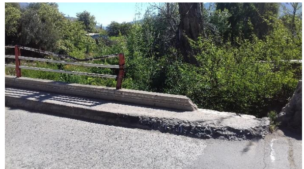
Figura 8-83 baranda y parte de la vereda rota
