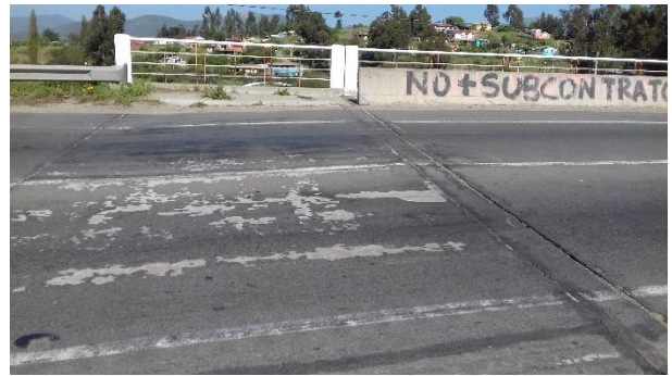
Figura 8-69 asfalto con daño, antes de entrar al puente
