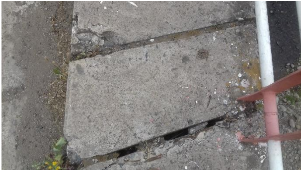
Figura 8-148 junta de expansión obstruida
