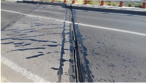
Figura 8-93 Junta de expansión deformada
