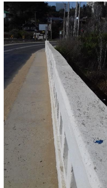
Figura 8-22 Baranda de hormigón deformada
