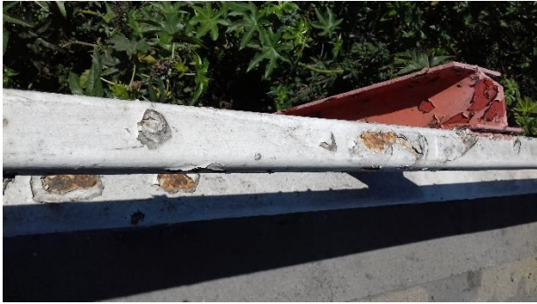
Figura 8-15 Baranda de acero con oxidación y descascaramiento
