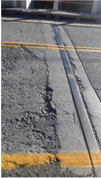
Figura 8-117 Baches en la vía
