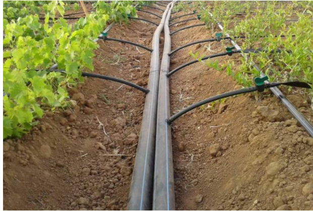
Figura 3.6: Tuberías de riego.
