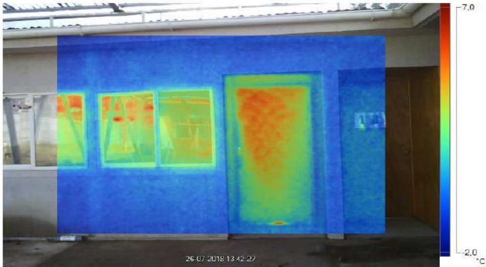
Figura 1-7 Fotografía de cámara termográfica en puertas y ventanas pabellón 1 Fuente: CEGA
