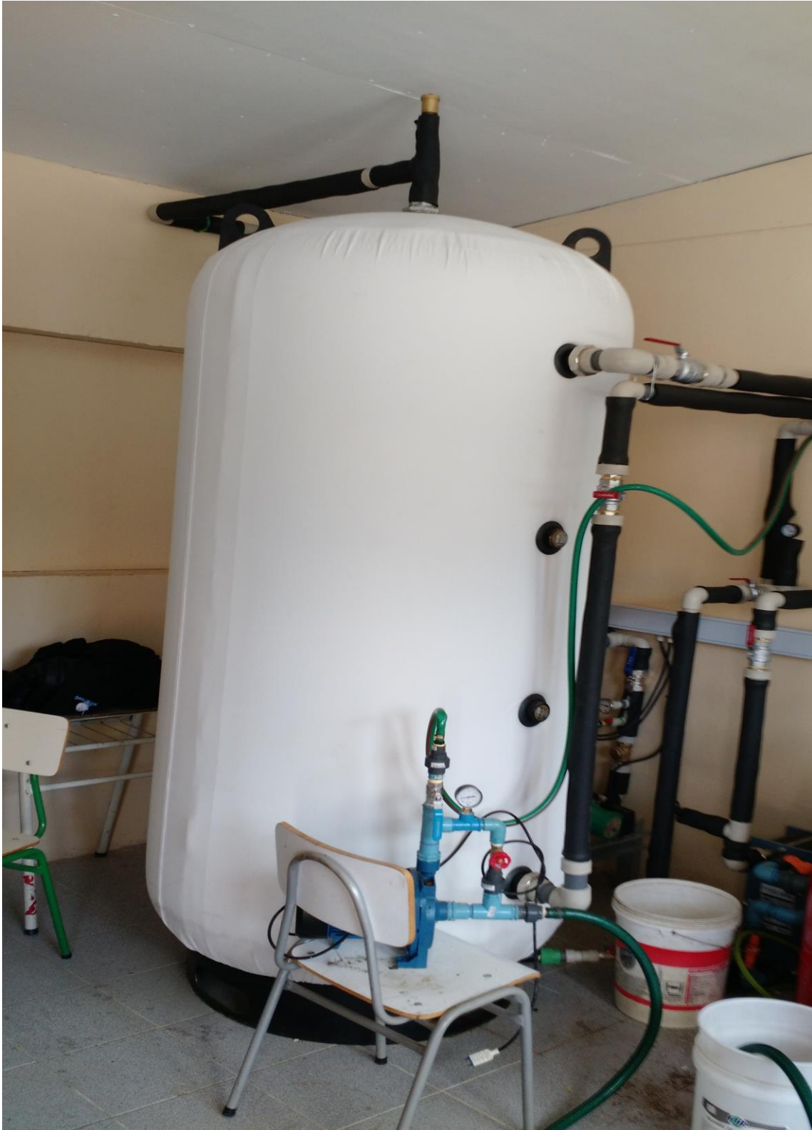
Figura 2-11 Estanque de almacenamiento del sistema de calefacción.
