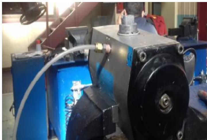
Ilustración 5-3-2: Conexión a la entrada del actuador.
