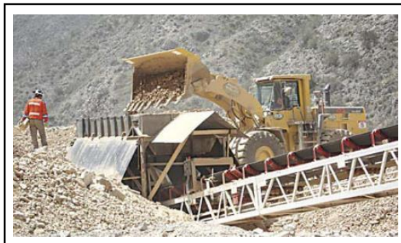
Figura 3-43. Tolva de carga de minerales
