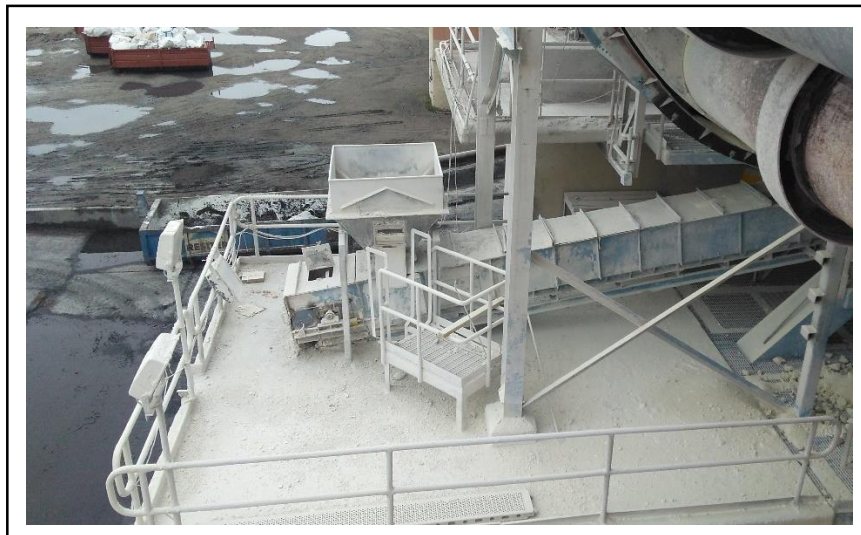
Figura 3-22. Transportador auxiliar de Cal
