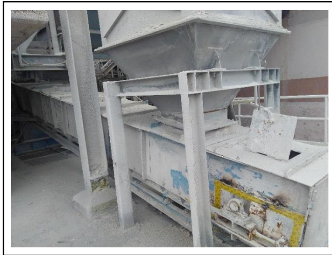
Figura 3-23. Transportador auxiliar de cal, lado norte
