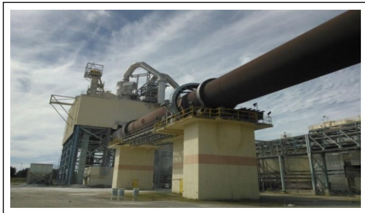
Figura 2-15. Horno de cal línea 2 Celulosa Arauco
