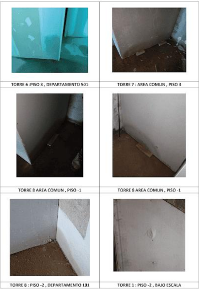
Figura 2-15 Informe Estado TabiQUES - Fuente: Registro persona
