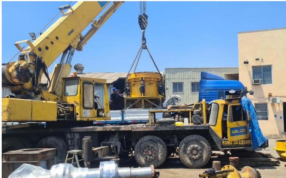
Figura 1-9. Estado actual de la grúa de izaje
