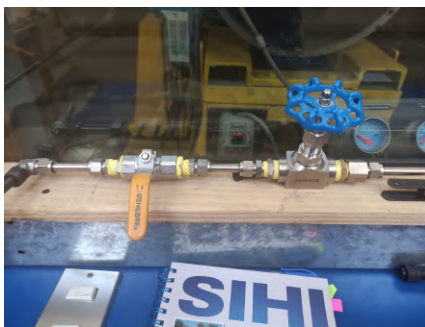
Figura 4.14: Válvula de bola y válvula de globo.
