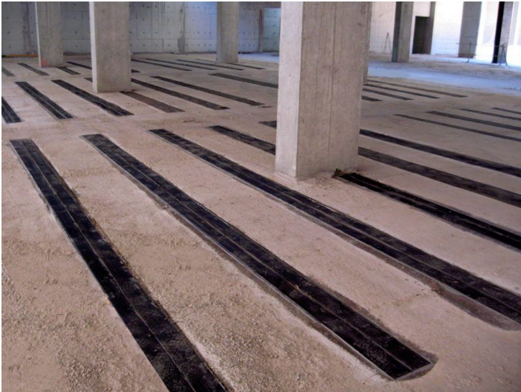
Figura 2.8. Refuerzo estructural por flexión con pletinas de CFRP en losas (fuente: Sika S.A.).
