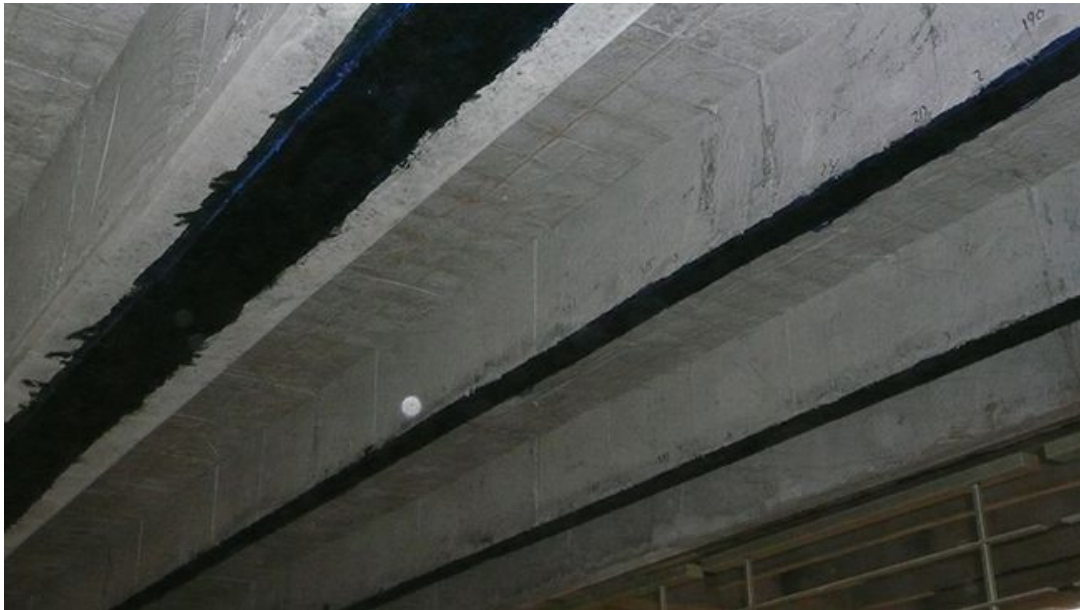
Figura 2.5. Refuerzo estructural por flexión con pletinas de CFRP en vigas (fuente: Sika S.A).
