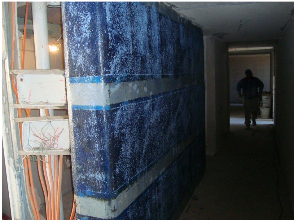
Figura 2.6. Refuerzo estructural de corte con tejidos de CFRP en muros (fuente: IE3 Ingeniería Estructural).
