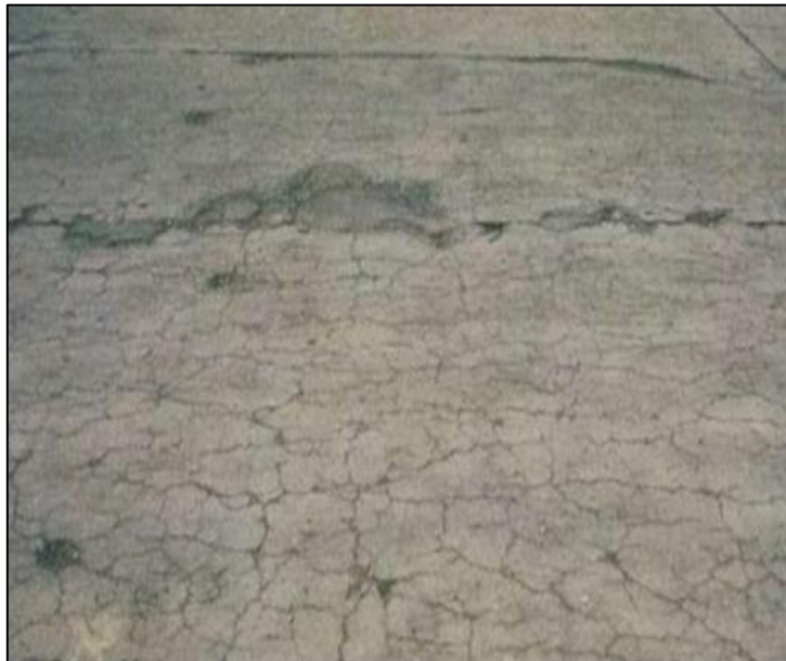
Figura 8: Fisura Superficial - Map Cracking [FHWA,2003]
