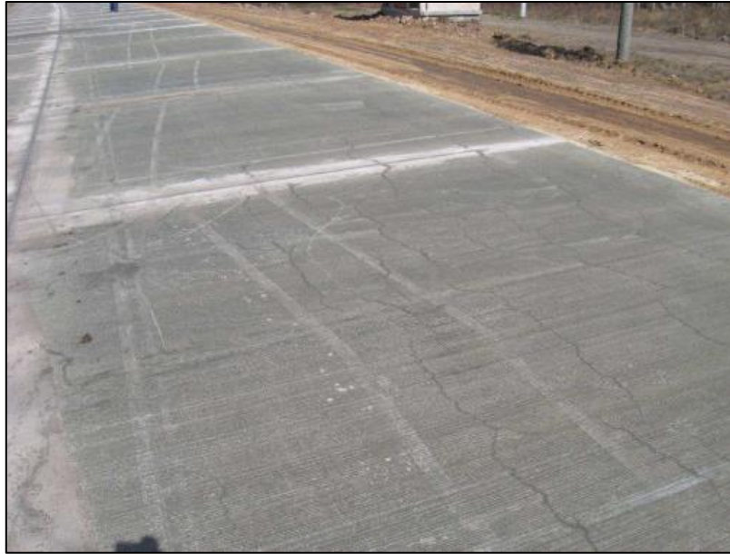
Figura 7: Fisura por Contracción [Souza,2011].
