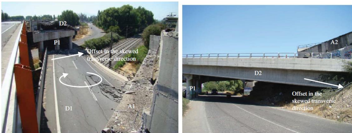
Figura 2-3 - Daño en Puente Hospital [4]
