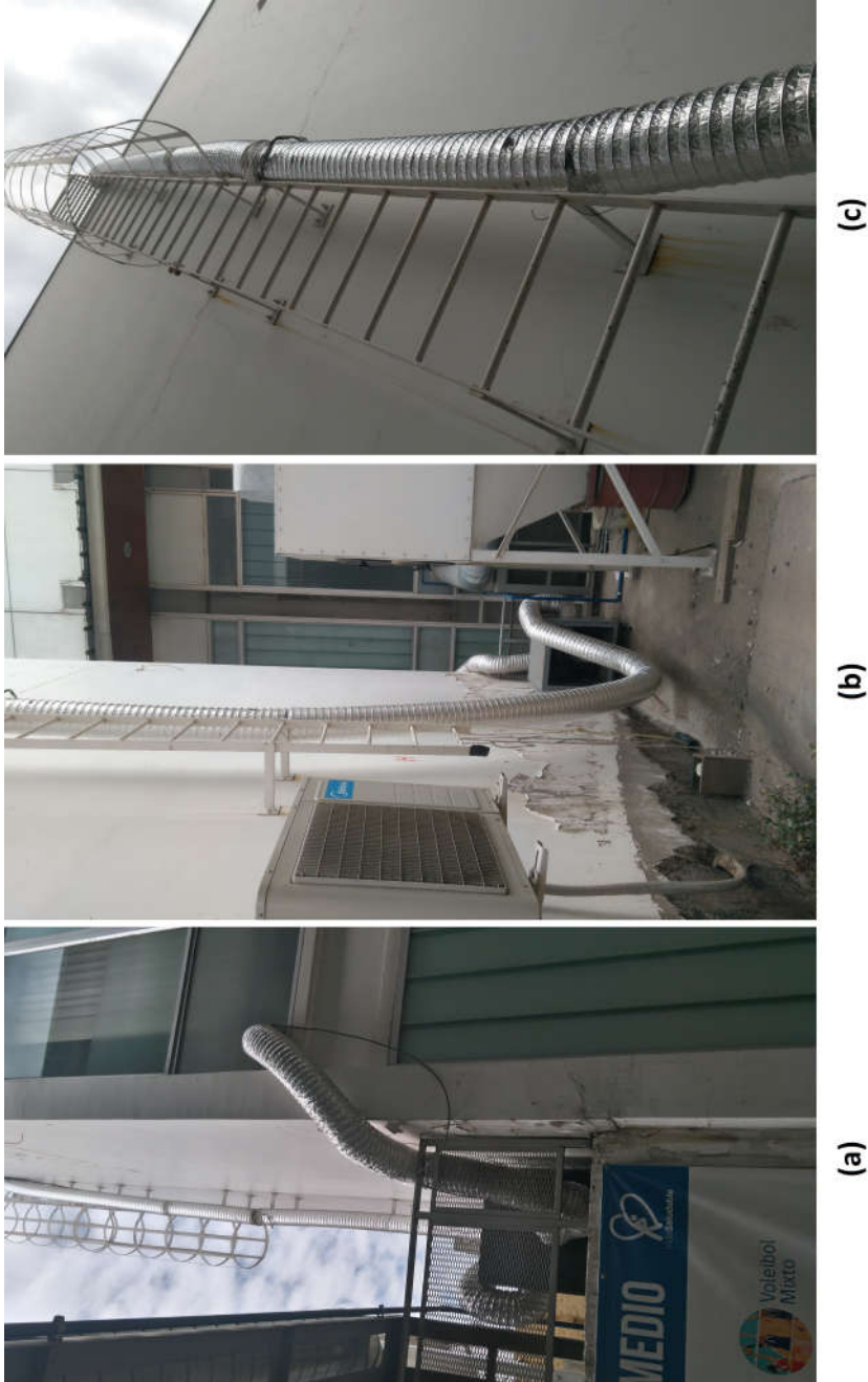
Figura 8.8: Registro de la extracción de la cortadora láser vista por fuera del laboratorio, 10 de septiembre del 2019 (a) Salida directa del tubo de extracción por una perforación en la ventana (b) Continuación del tubo por el costado exterior oriente del laboratorio (c) Final del tubo por la parte superior del edificio.
