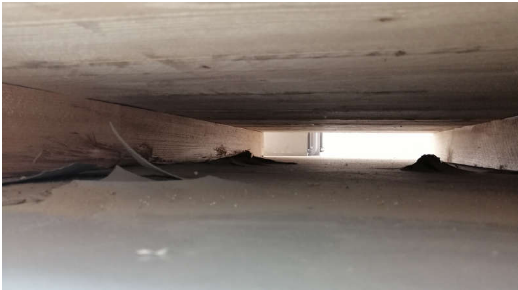
Figura 8.37: Registro del espacio al día 12 de marzo del 2020, fracturas en el piso bajo la caja de la máquina sinterizadora.
