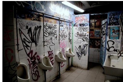
Figura 18 - Baño público en mal estado. Nota. Fuente: La Tercera, 2022, https://www.latercera.com/que-pasa/noticia/cual-es-el-riesgo-de-usar-banos-publicos-es-lo-que-explican-dos-cientificos/VPIUBAOHSBDEDDGGJTXF5PH5HXQ/
