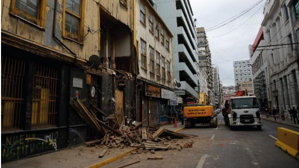
Figura 3– Deterioro de fachada de edificio histórico (Bar Inglés). Nota. Fuente: Observador.cl, 2021, https://www.observador.cl/videos-fachada-del-bar-ingles-de-valparaiso-se-derrumbo-vecinos-lo-habian-advertido/bar-ingles-valparaiso-derrumbe-desplomo-fachada/
