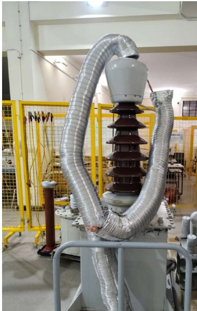
Figura 7.8: Transformador utilizado en los ensayos
