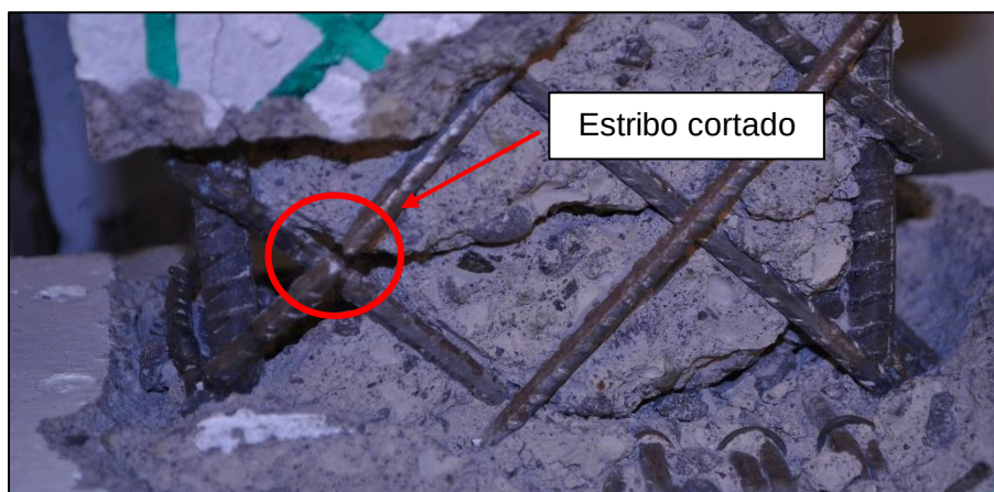
Figura 95. Estribo cortado lejos del punto de soldadura.
