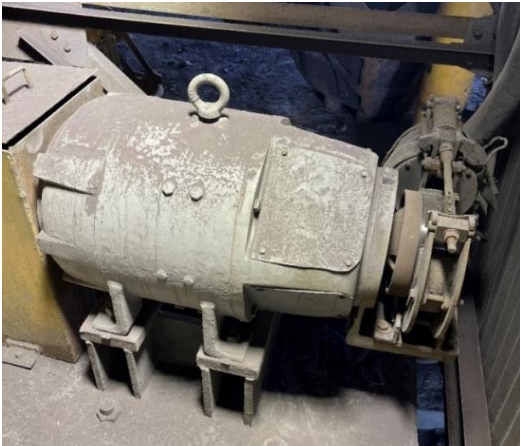
Fuente: Elaboración propia (registro fotográfico personal en Fundición Potrerillos, 2025).
