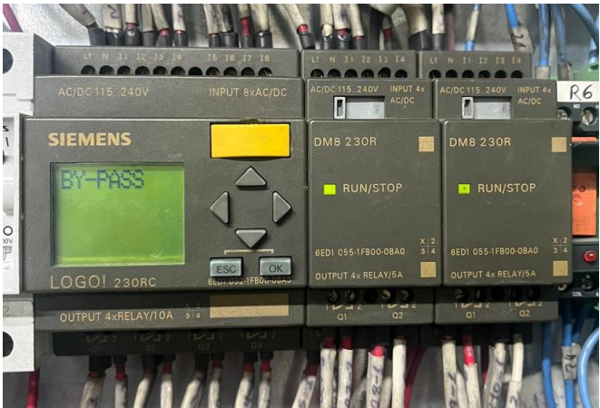
Fuente: registro fotográfico propio, Sala Eléctrica CPS y Hornos de Ánodos.
