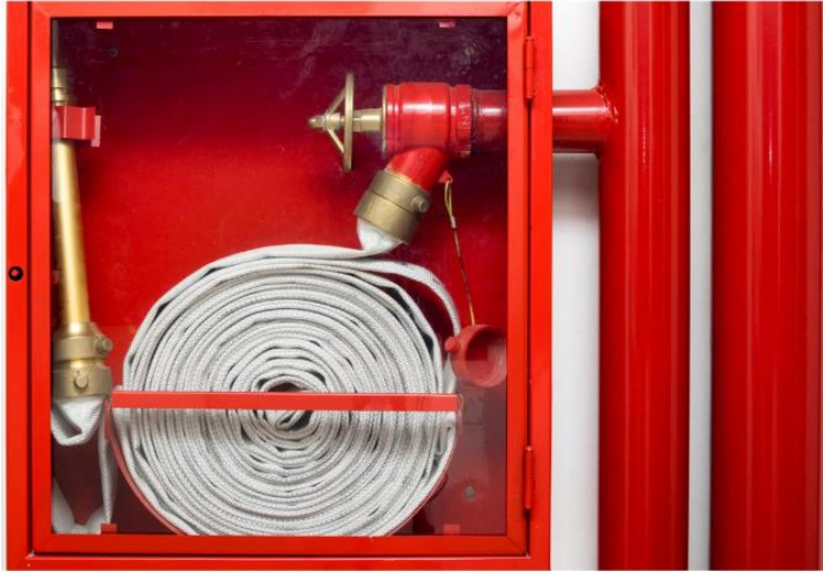
Figura N° 5: Red Húmeda (Gabinete, carrete de manguera y pitón)
