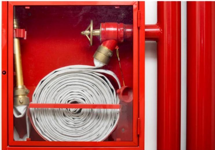
Figura N° 1: Red Húmeda (Gabinete, carrete de manguera y pitón)
