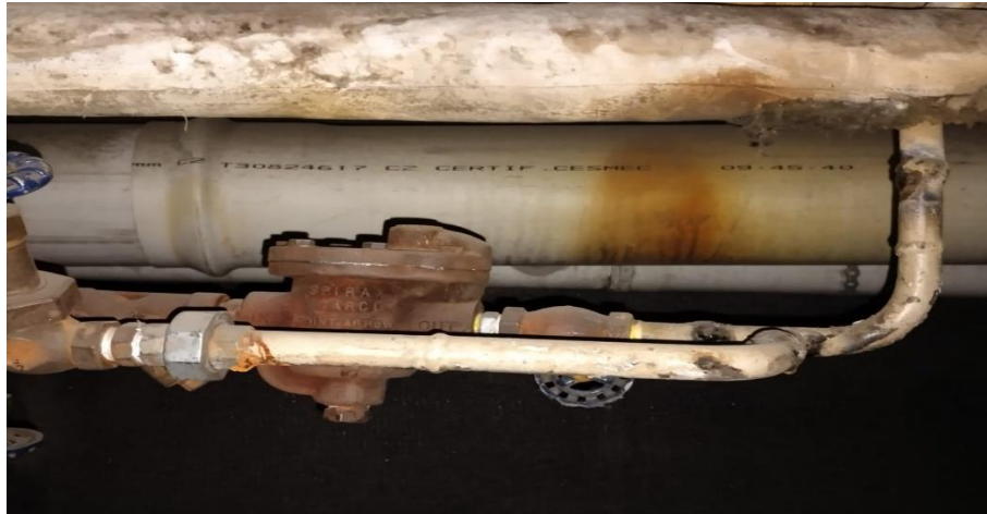
Figura 2-2 Cañerías de vapor piso mecánico
