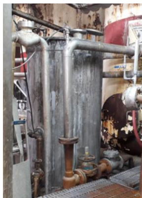
FIGURA 1- 9: Sistema Manual de Dosificación de reactivos.
