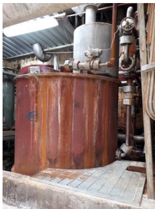
FIGURA 1- 10: Corrosión en elemento del Sistema.
