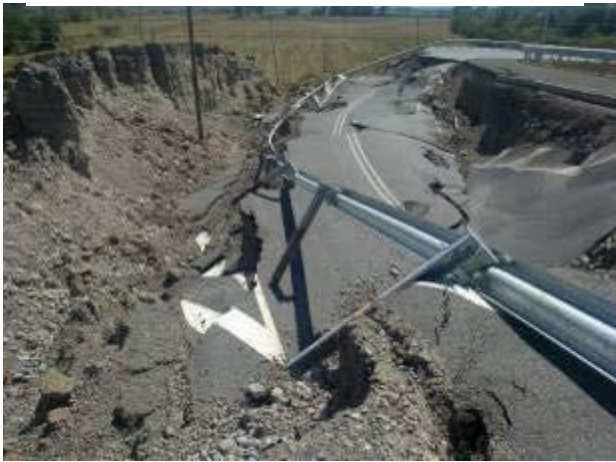
Figura 5 Enlace Villaseca: Colapso por licuefacción de terraplén poniente.
