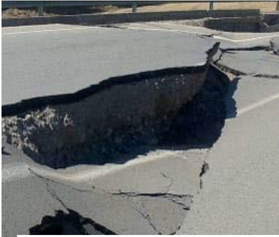
Figura 4 Enlace Retiro Daño Terraplenes de acceso
