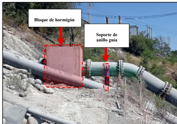
Figura 18: Soportación de la línea.
