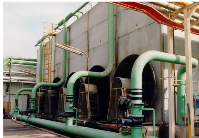
Ilustración 3-11: Torre de refrigeración de tiro forzado.
