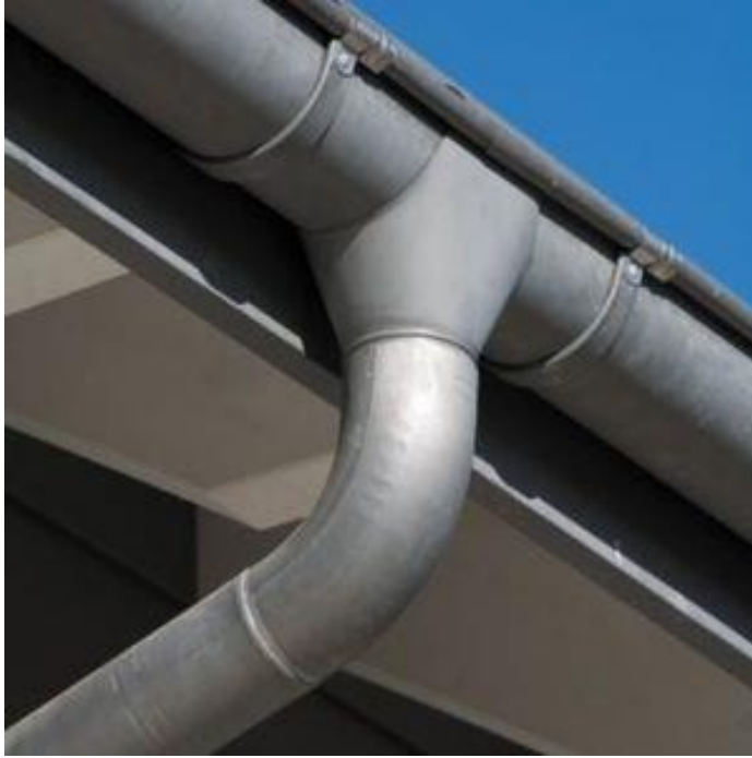
Figura 3-7: Canaleta de techo (fuente: www.archiexpo.com )
